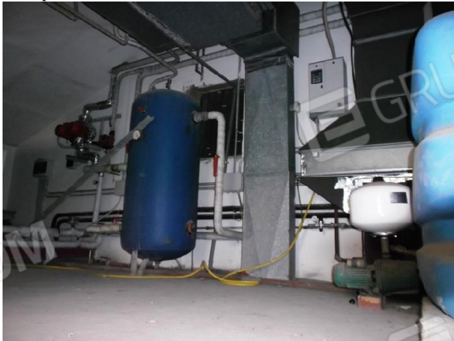
2 piano Sottotetto – centrale di climatizzazione e ventilazione
