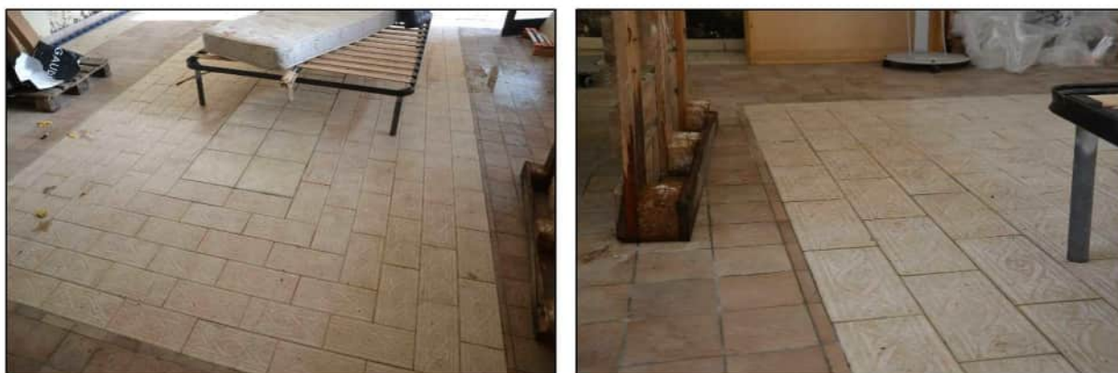
Figura 18 - Presenza di acqua stagnante nel DEPOSITO 1
