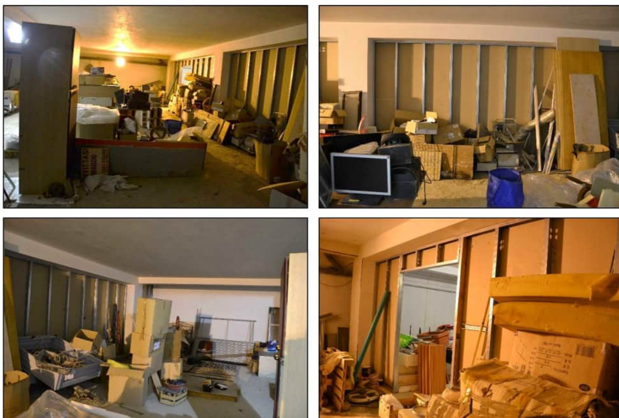
Figura 22 – Tramezzature in cartongesso incomplete
