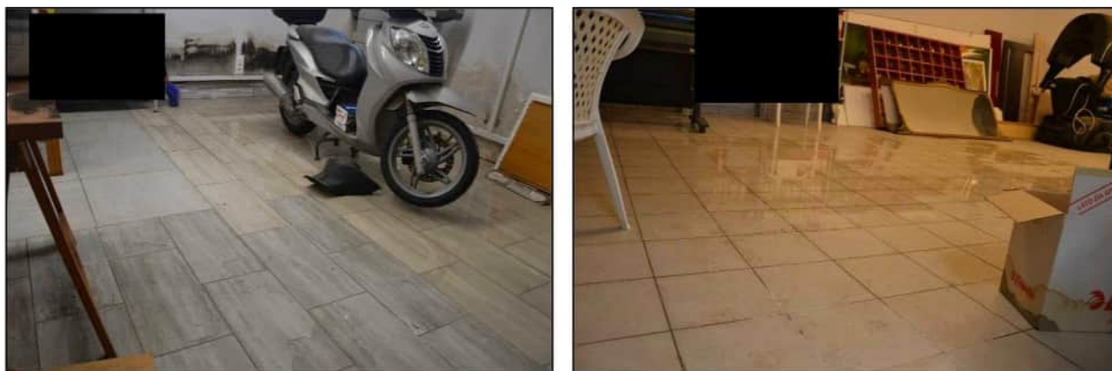
Figura 20 - Presenza di acqua stagnante nel DEPOSITO 2
