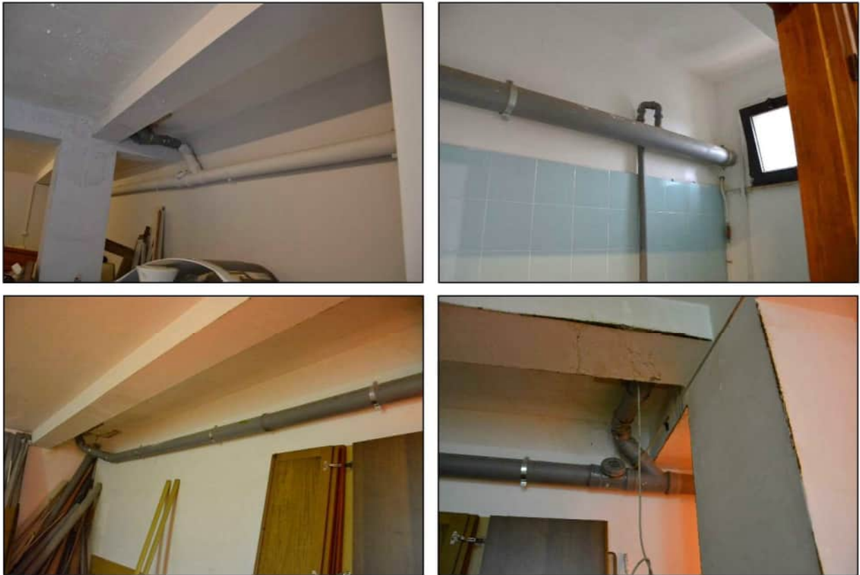
Figura 23 - Tubazione fognaria condominiale
