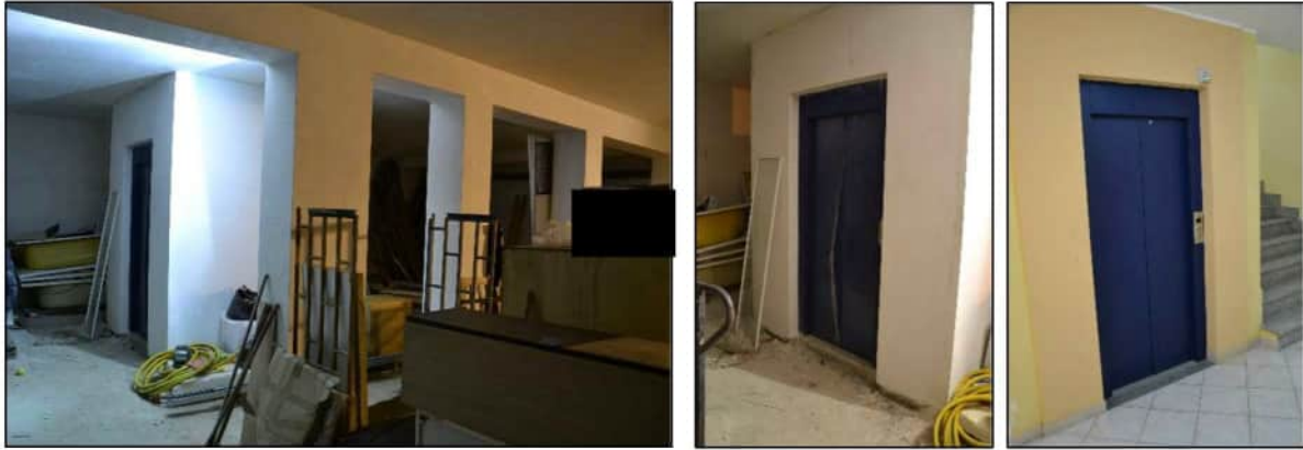
Figura 14 - Vano ascensore presente nel DEPOSITO 2. A destra accesso al vano ascensore dal piano terra del fabbricato
