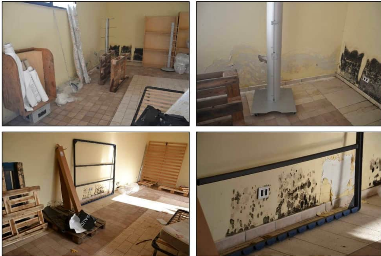
Figura 17 - Deterioramento delle finiture a causa delle infiltrazioni nel DEPOSITO 1
