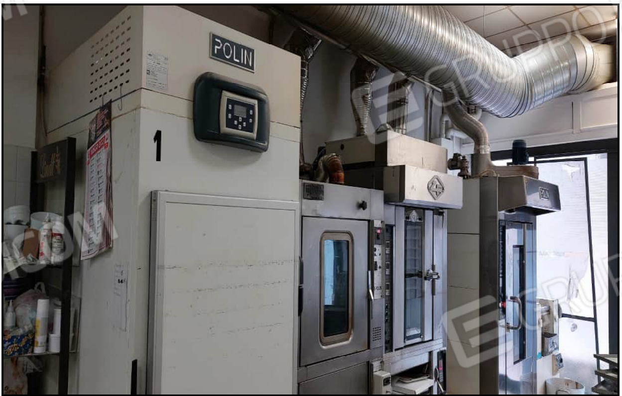
Foto 4. Vista frigoriferi e impiantistica del locale
