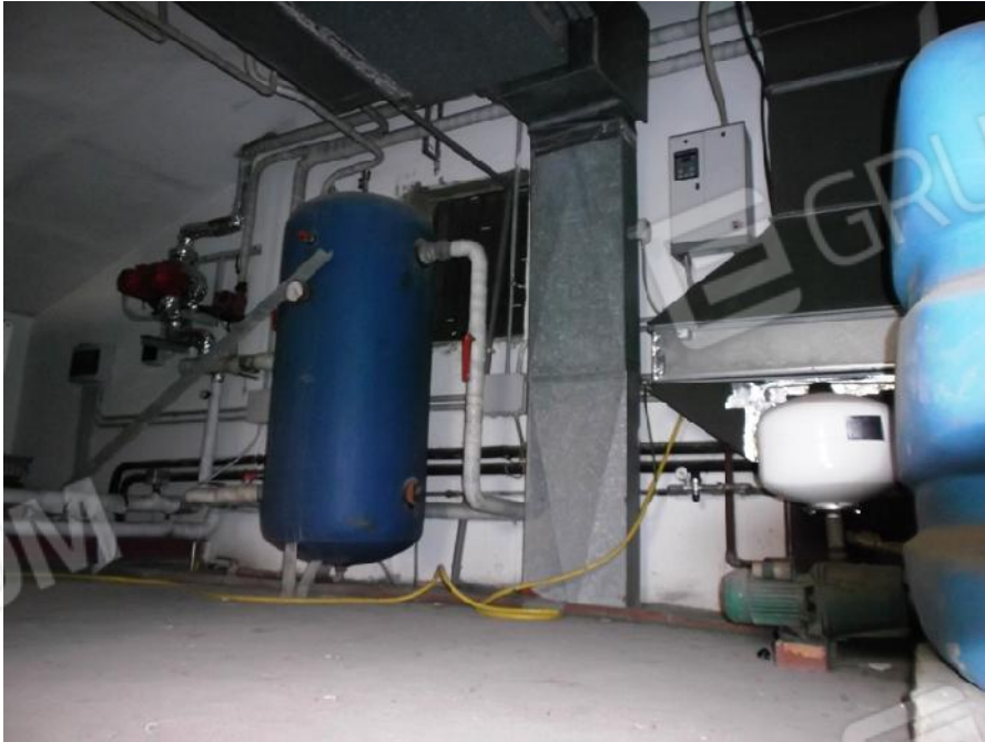
2 piano Sottotetto – centrale di climatizzazione e ventilazione
