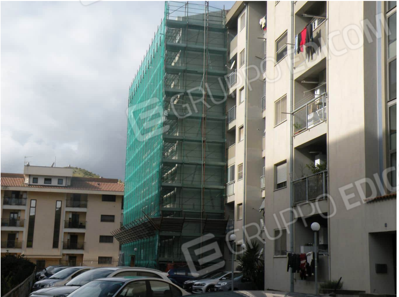
Foto n° 3 – Condominio Via dei Conti Falluc n° 70 – Scala A - Prospetto Sud ( coperta da impalcatura)
