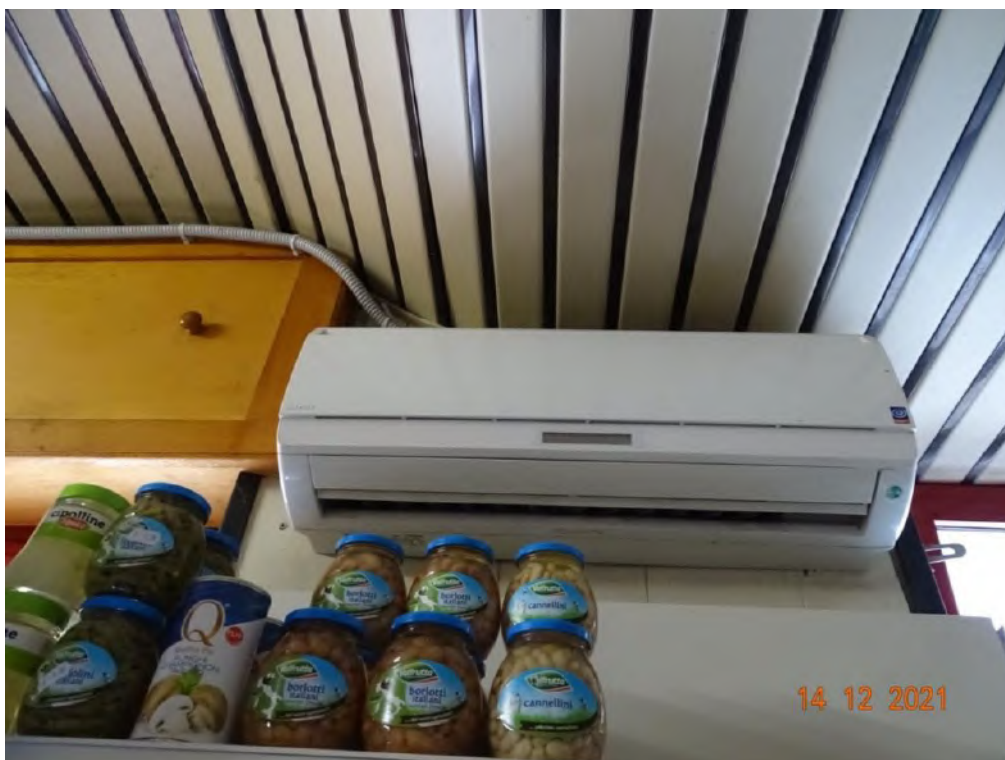
Foto 16 – Particolare del secondo condizionatore immobile “B”
