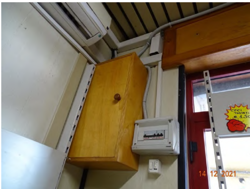
Foto 14 – Particolare quadro elettrico immobile “B”
