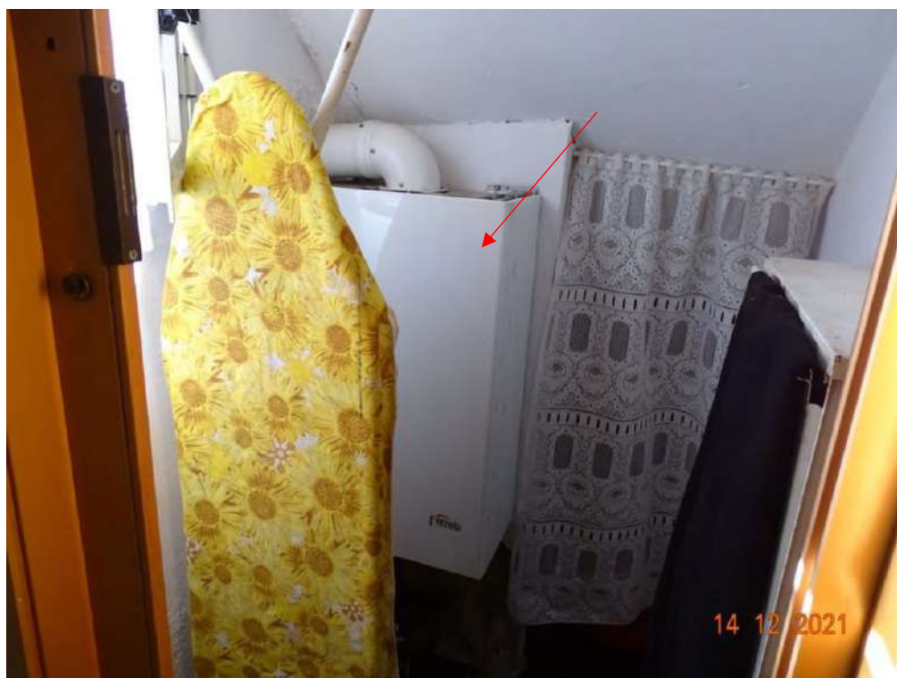
Foto 10 – Particolare caldaia posta nel sottoscala immobile “A”
