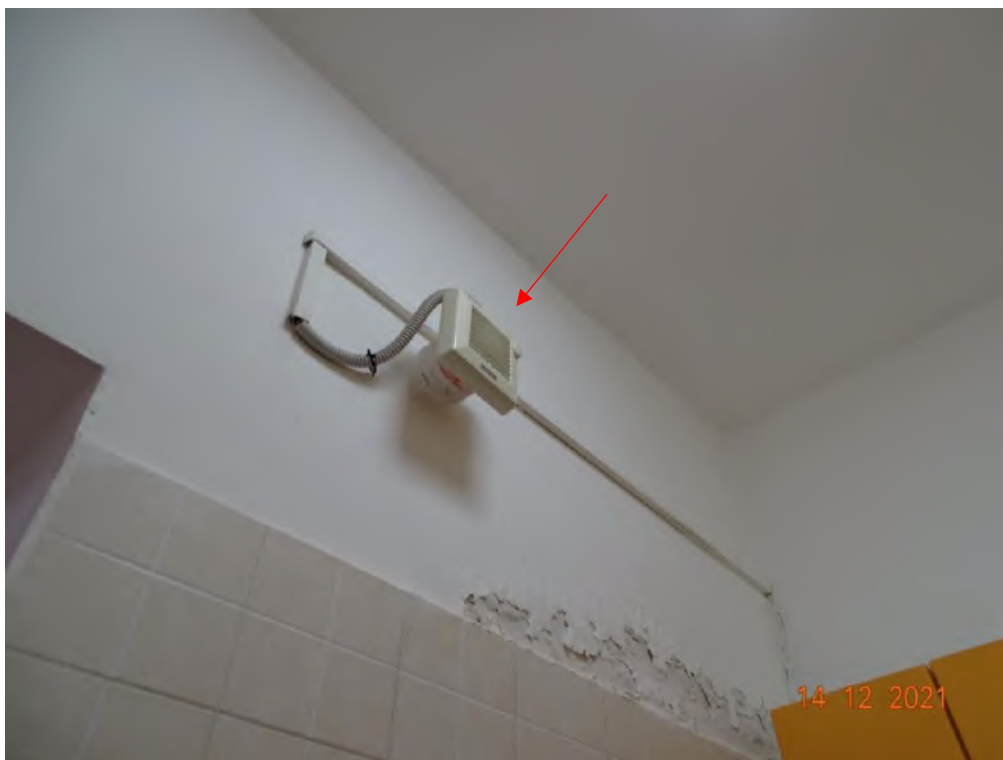
Foto 5 – Particolare della ventilazione forzata della cucina immobile “A”
