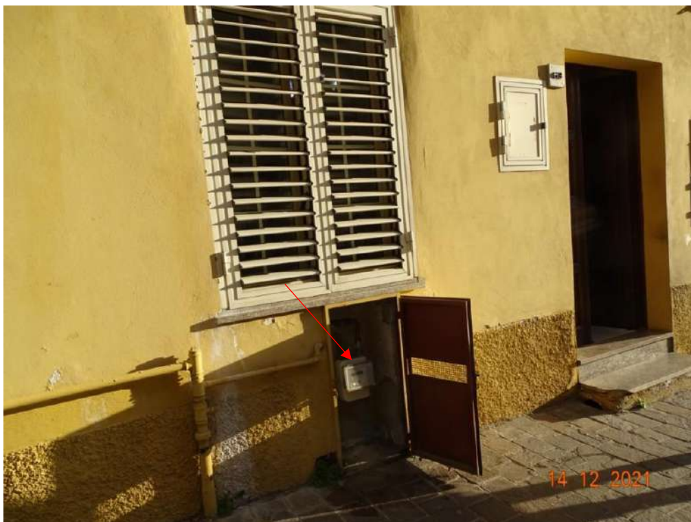
Foto 10 – Particolare vano misuratore Gas immobile “A”
