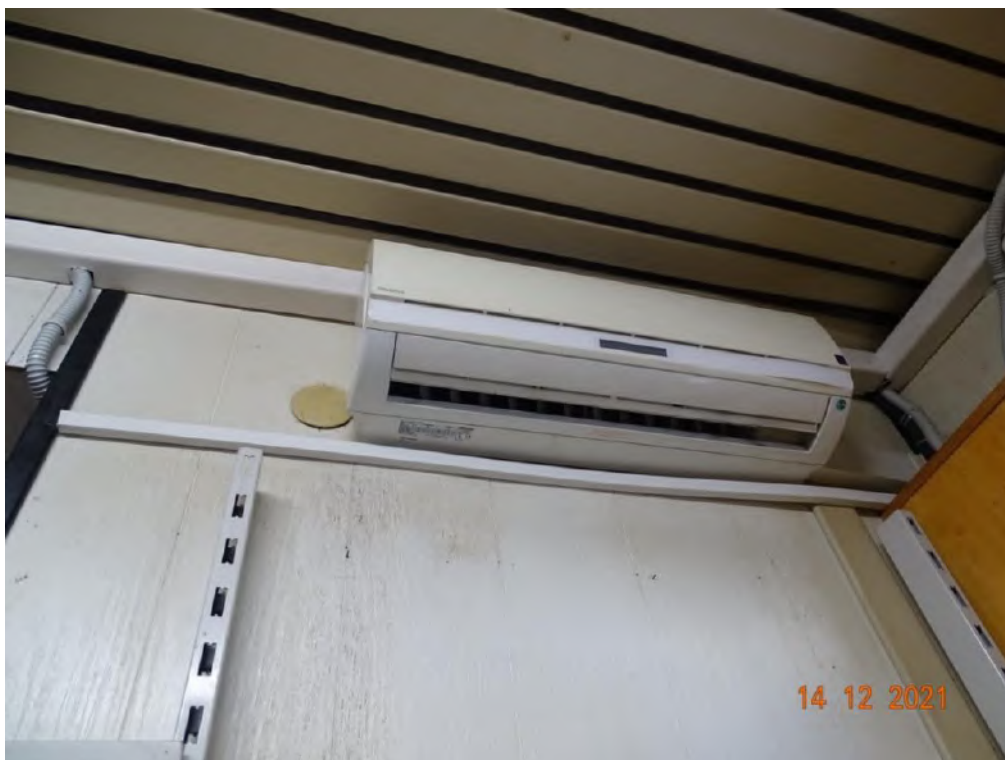
Foto 15 – Particolare del primo condizionatore immobile “B”
