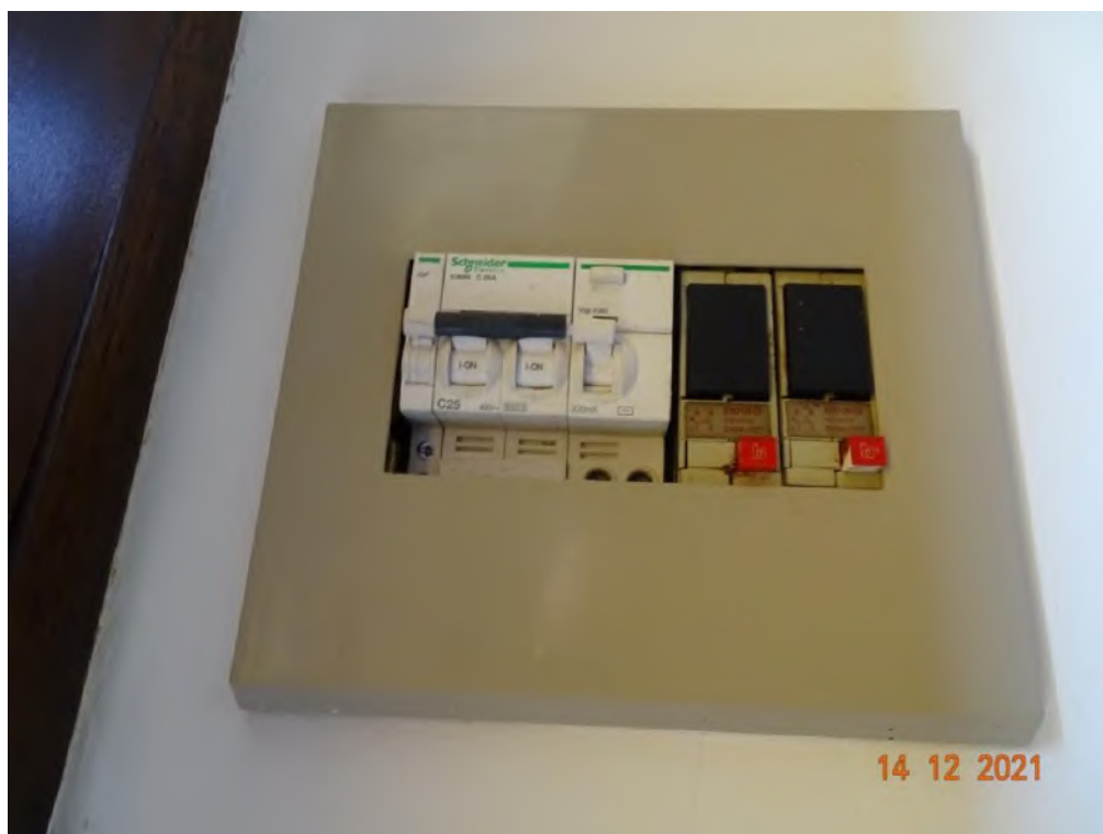
Foto 9 – Particolare Quadro Elettrico immobile “A”
