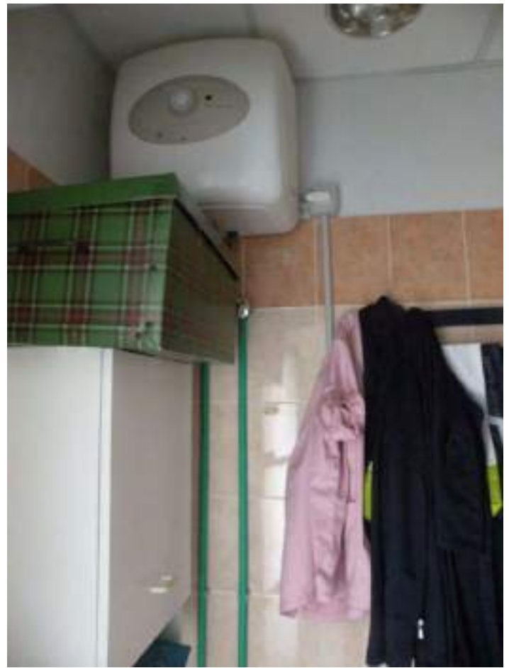
Foto n°43 – Immobile censito nel N.C.E.U. al fg 64 par.la 148 sub31 - Locale tecnico
