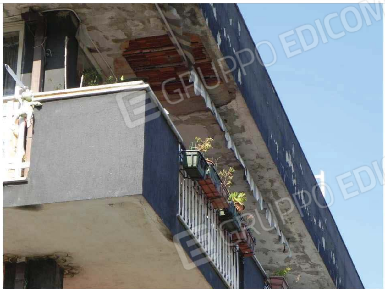
Foto n.5: prospetto lato SUD – particolare pignatte scoppiate
