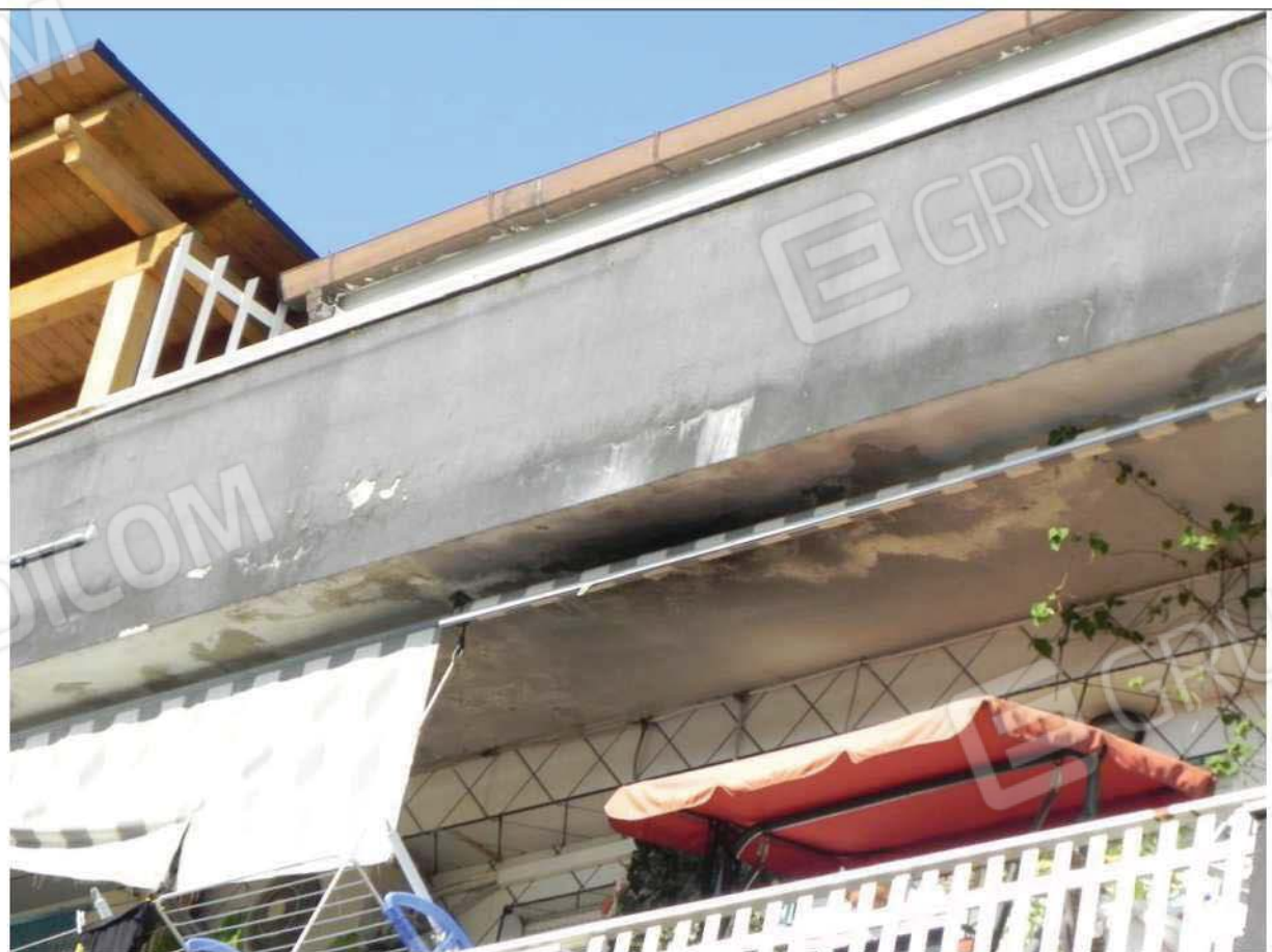
Foto n.6: prospetto lato OVEST – particolare succieli deteriorati
