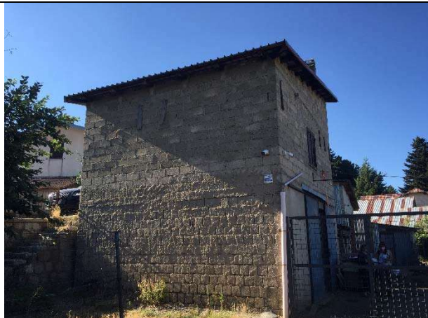
VISTA PRIMO FABBRICATO A COMINCIARE DA SUD LIVELLO -1 SU STRADA DI SERVIZIO
