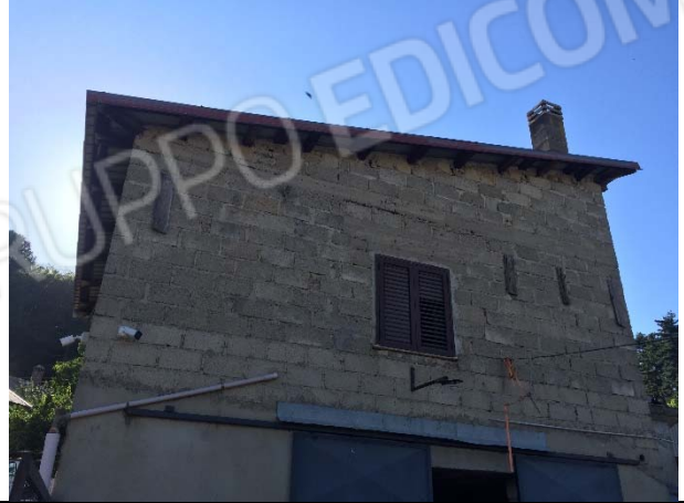
VISTA INGRESSO PRIMO FABBRICATO A COMINCIARE DA SUD - LIVELLO -1 SU CORTE INTERNA FRONTE EST
