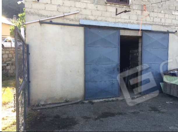
VISTA INGRESSO PRIMO FABBRICATO A COMINCIARE DA SUD - LIVELLO -1 SU CORTE INTERNA FRONTE EST
