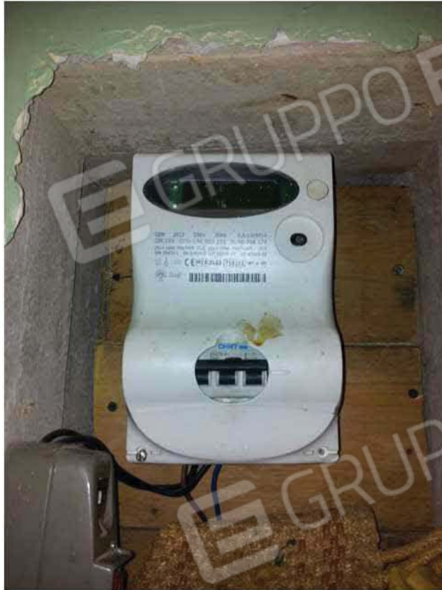
Foto 41 – Unità immobiliare in traversa di via Padolisi: contatore energia elettrica.
