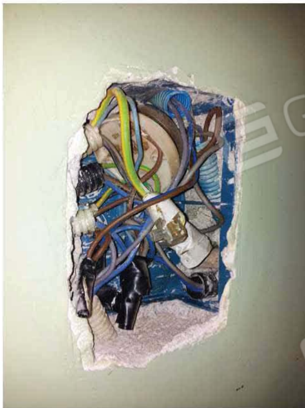
Foto 42 – Unità immobiliare in traversa di via Padolisi: particolare dell'impianto elettrico.
