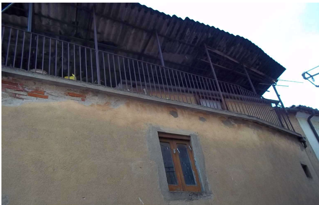
Foto n° 2 vista precaria copertura Fabbricato - lotto 1 -
