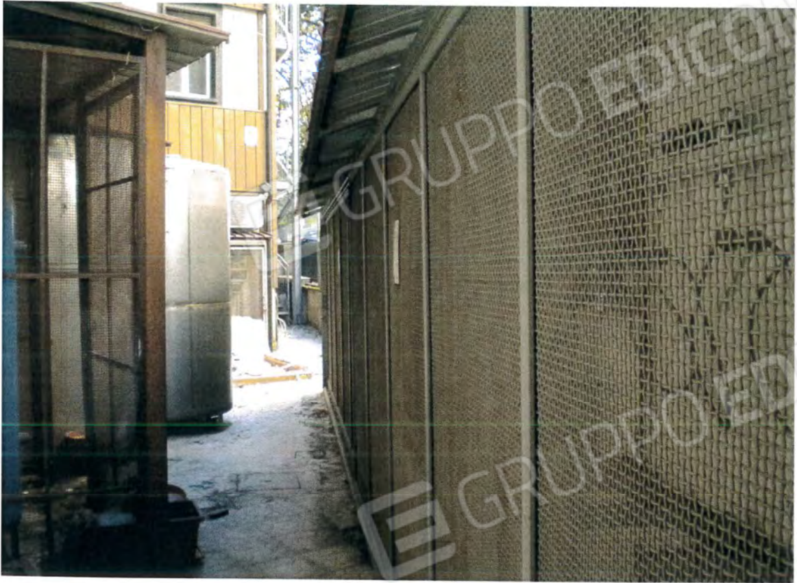
Foto 5: impianti tecnici posti nel cortile di pertinenza;
