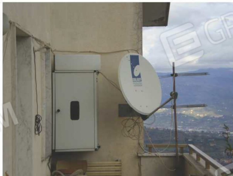
Foto n. 12 – Caldaia esterna (non funzionante) su balcone laterale
