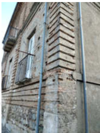
Foto n. 3 – Angolo largo Fontana (balcone immobile)
