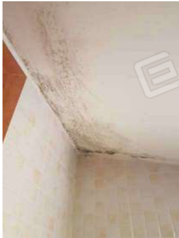
Foto 42: presenza di muffa
