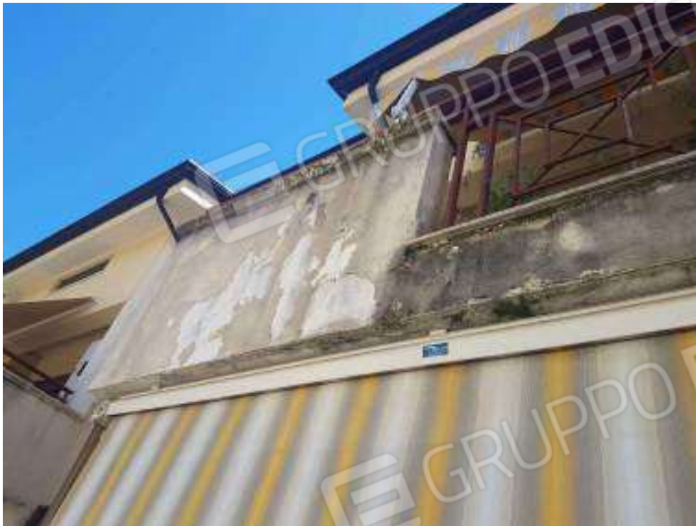
Foto 49: parete ammalorata e insalubre - palazzina
