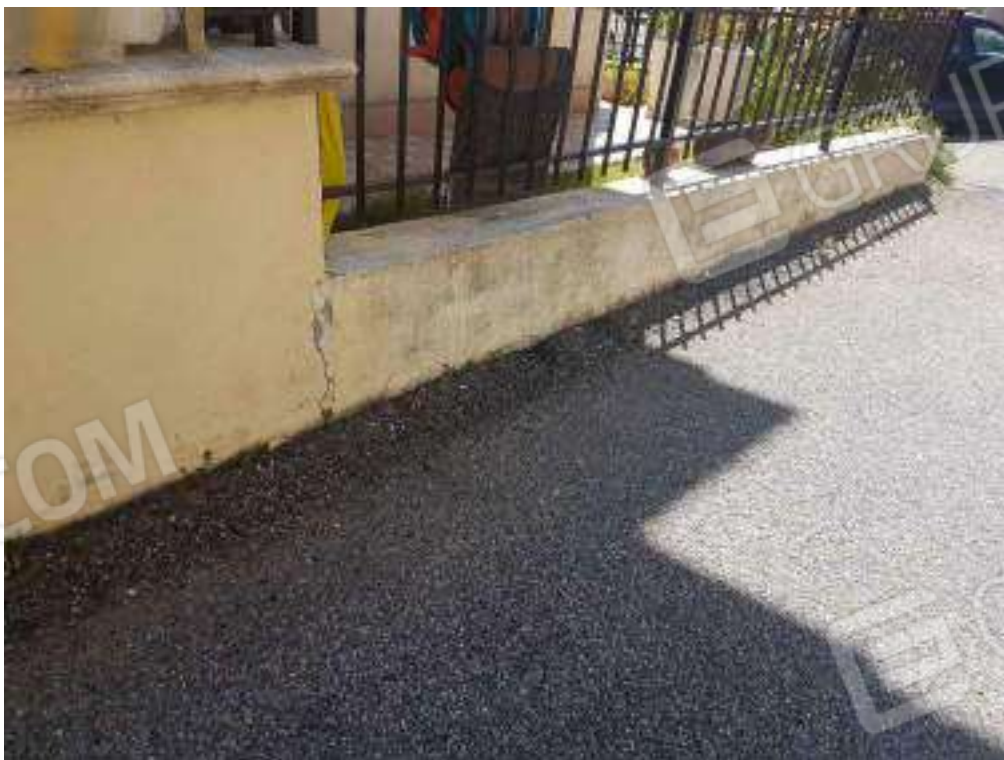
Foto 50: distacco intonaco - palazzina
