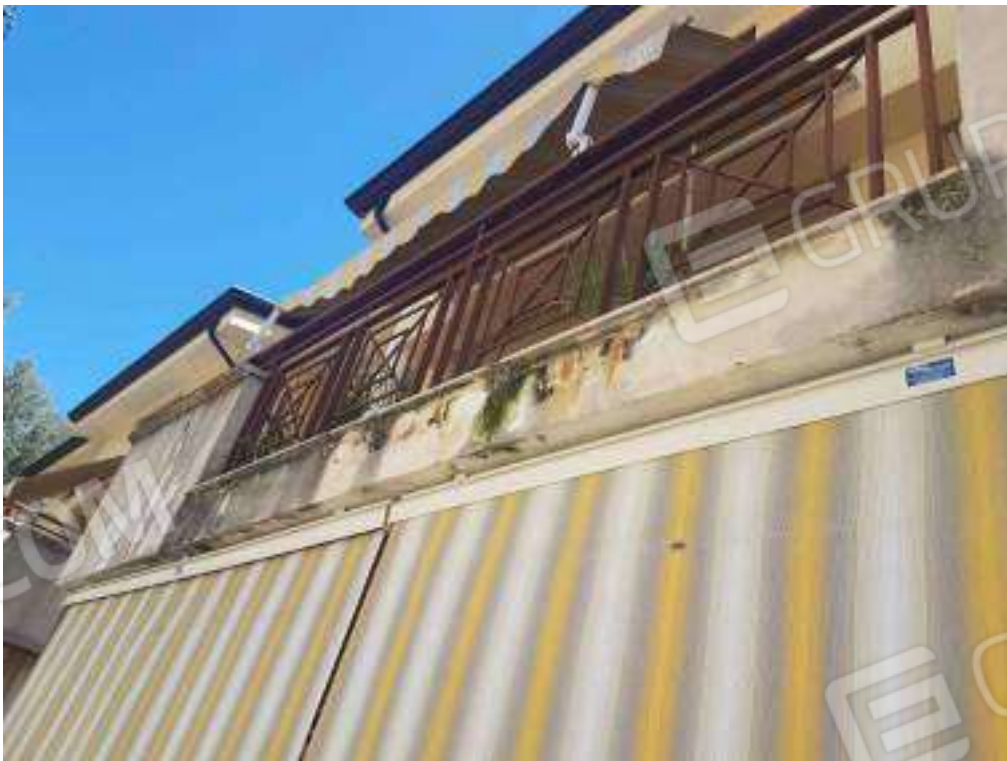
Foto 48: parete ammalorata e insalubre - palazzina
