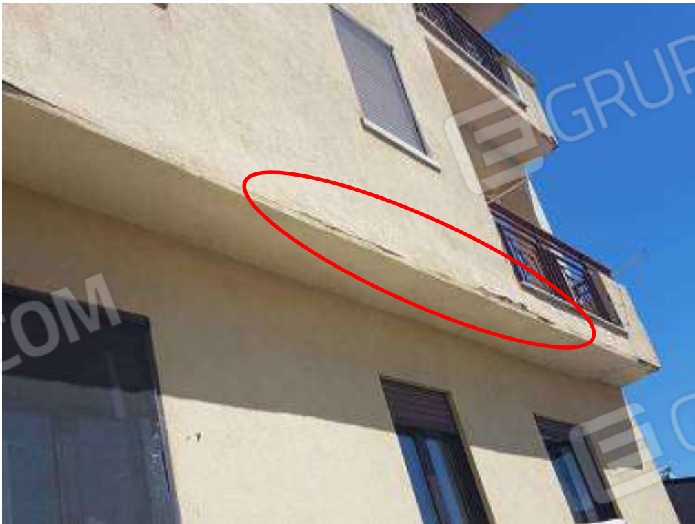
Foto 46: intonaco mancante - palazzina
