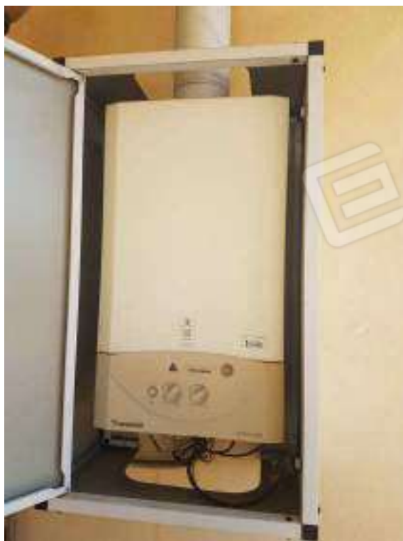
Foto 40: caldaia posizionata sul balcone
