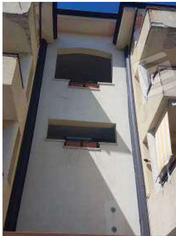
Foto 54: pareti ammalorate e esterno vano scala - palazzina
