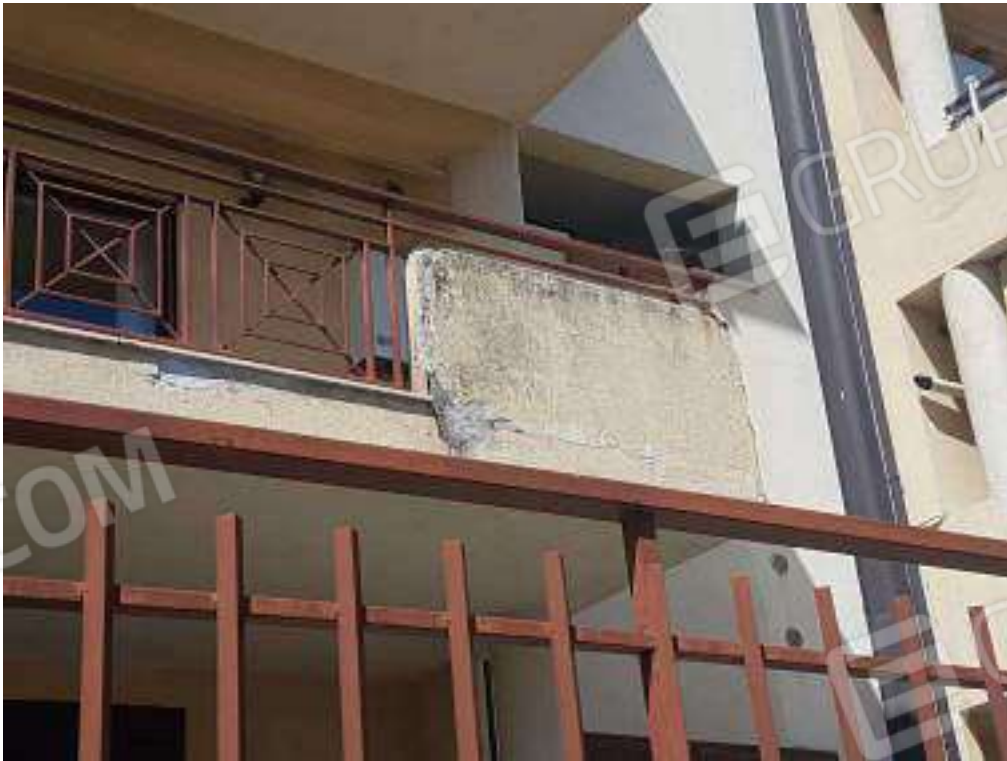
Foto 52: parete ammalorata - palazzina
