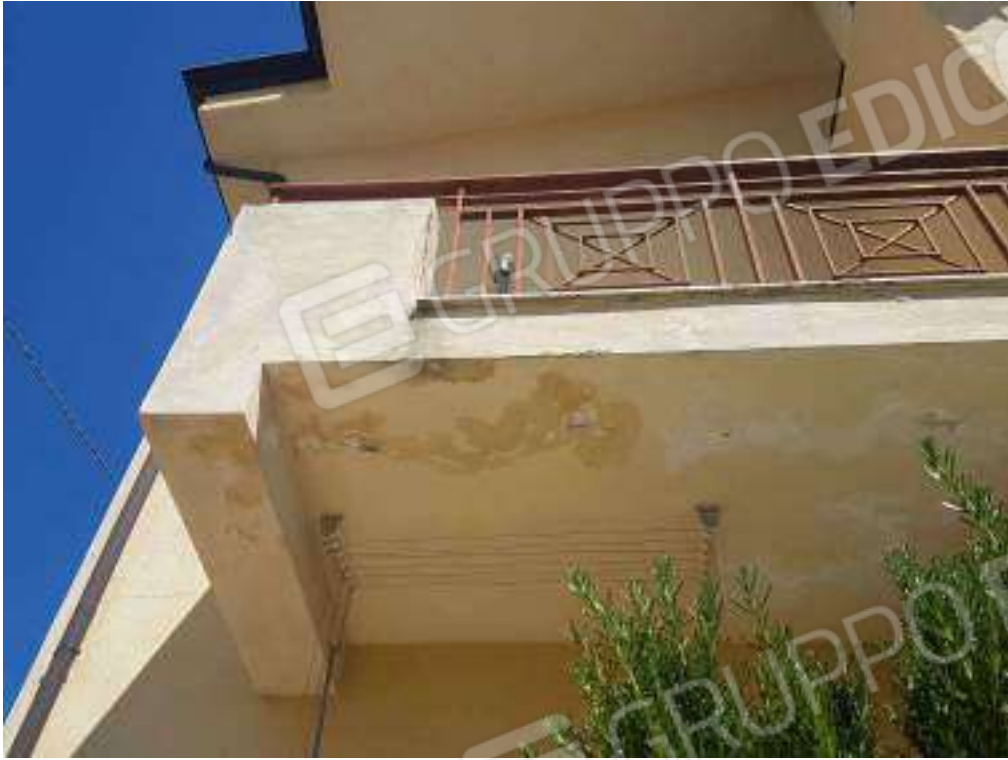
Foto 45: intonaco ammalorato e mancante - palazzina
