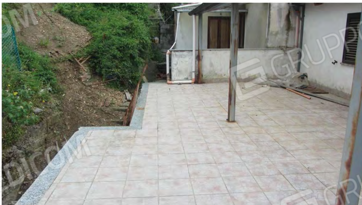
Lastrico solare con accesso incompleto
