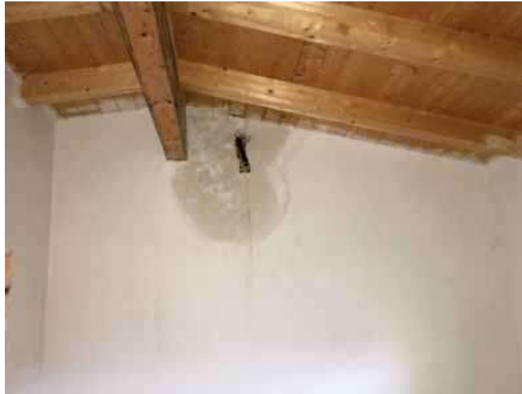
Figura 5: Segni di umidità rilevati al piano sottotetto
