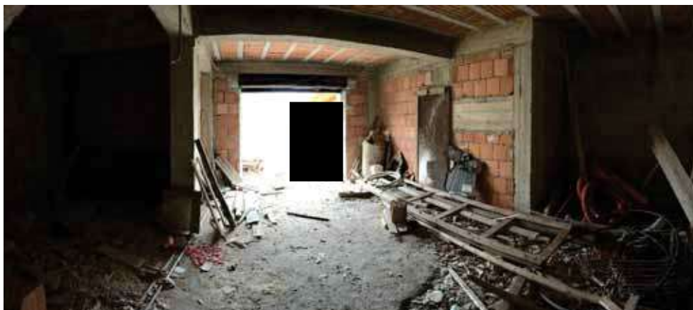
Figura 10: Abitazione pignorata piano seminterrato.
