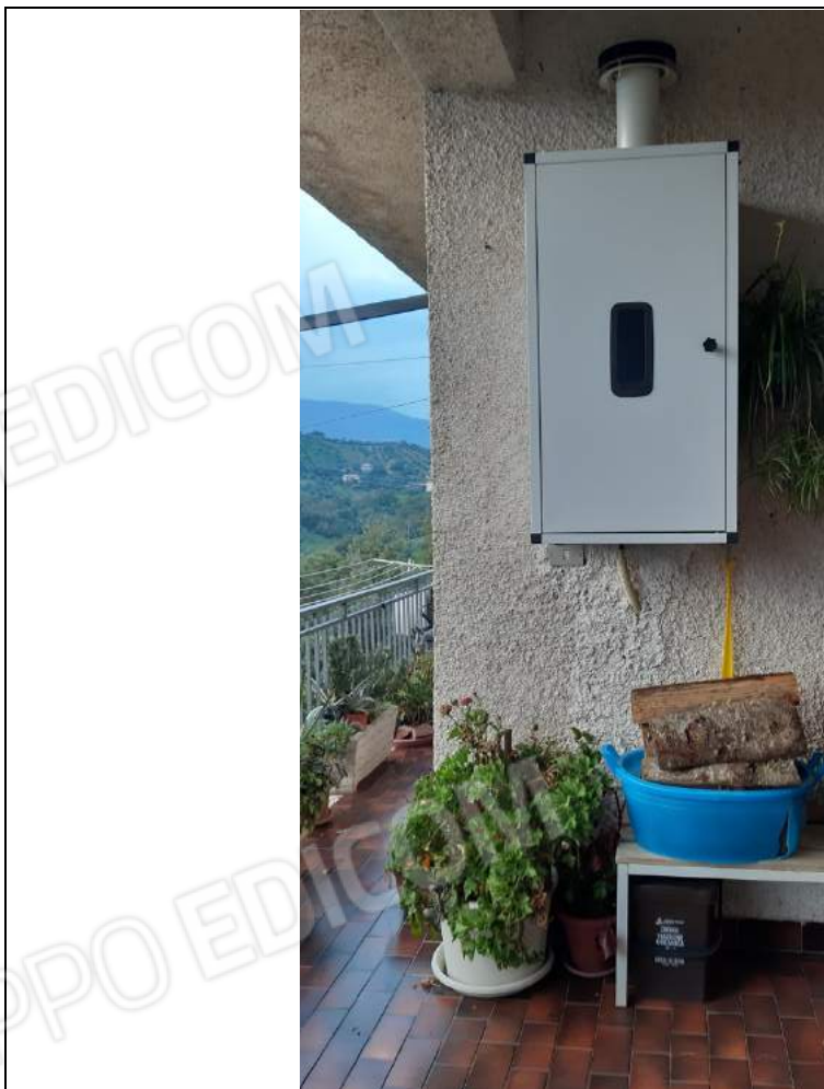
Foto n. 25: Particolare caldaia posta sul terrazzo
