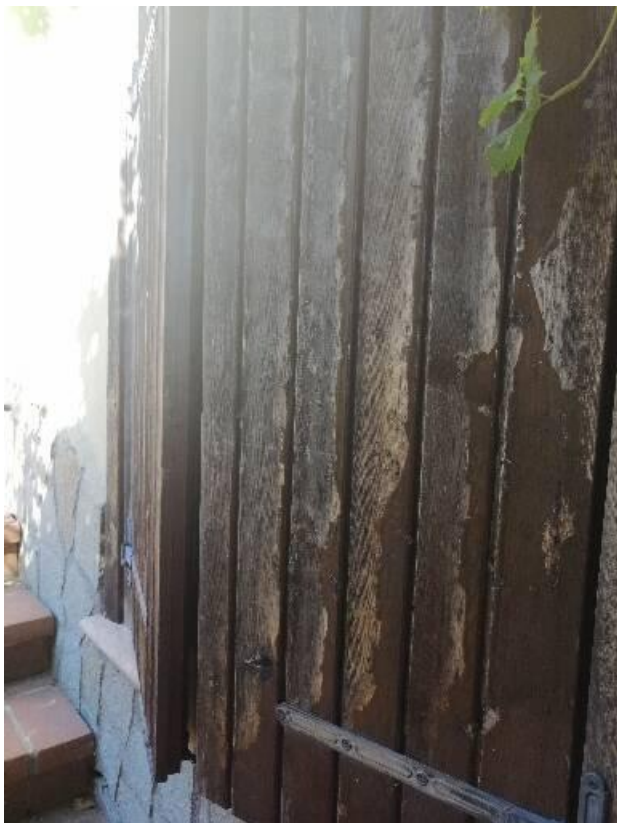
Fotografia 5 – Infissi esterni piano seminterrato
