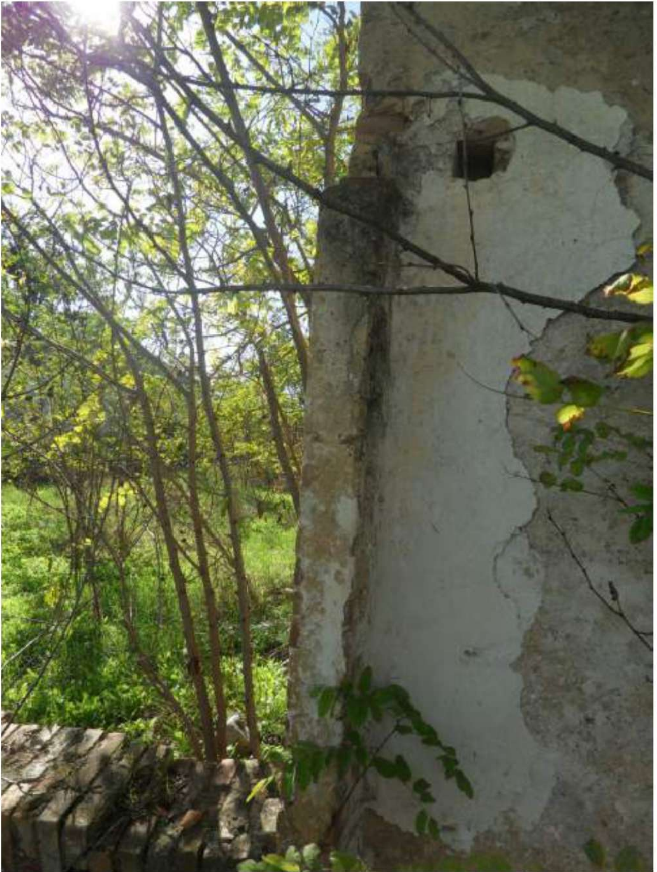
BENE N° 1 – FABBRICATO OBSOLETO (UNITA' COLLABENTE)
