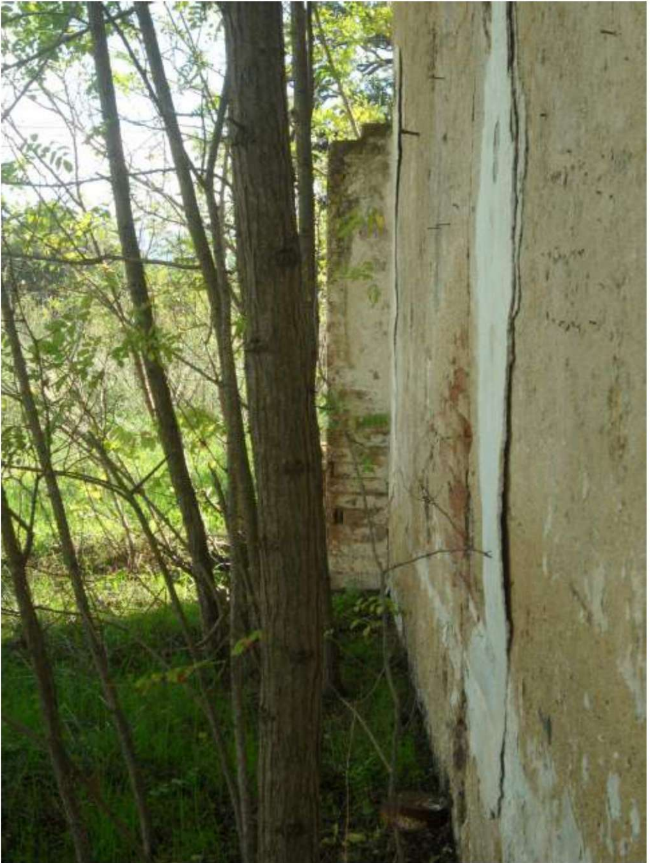
BENE N° 1 – FABBRICATO OBSOLETO (UNITA' COLLABENTE)
