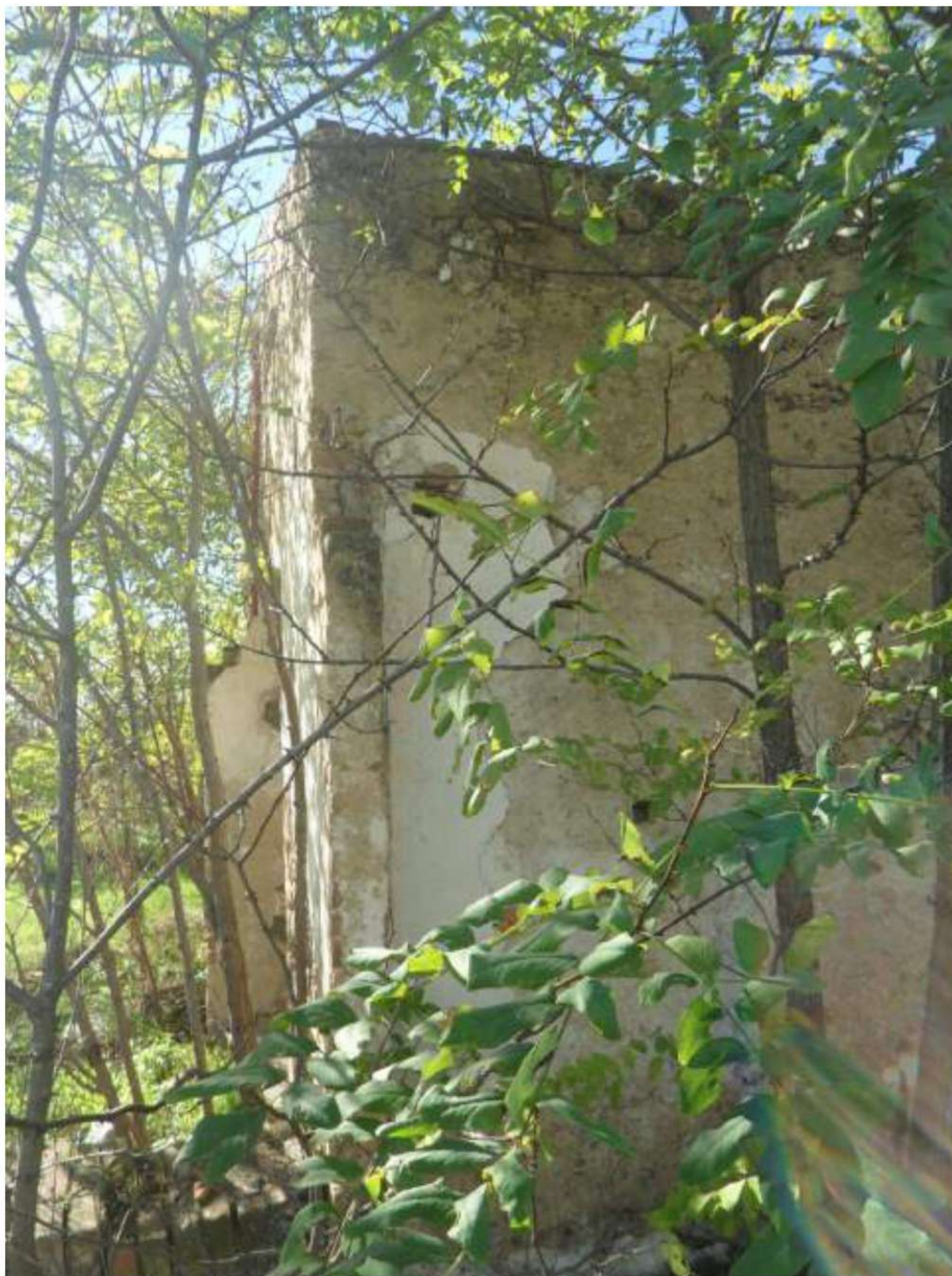
BENE N° 1 – FABBRICATO OBSOLETO (UNITA' COLLABENTE)
