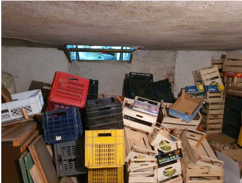
VISTA INTERNO SUB 6
