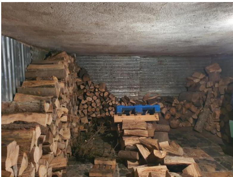
VISTA INTERNO SUB 6
