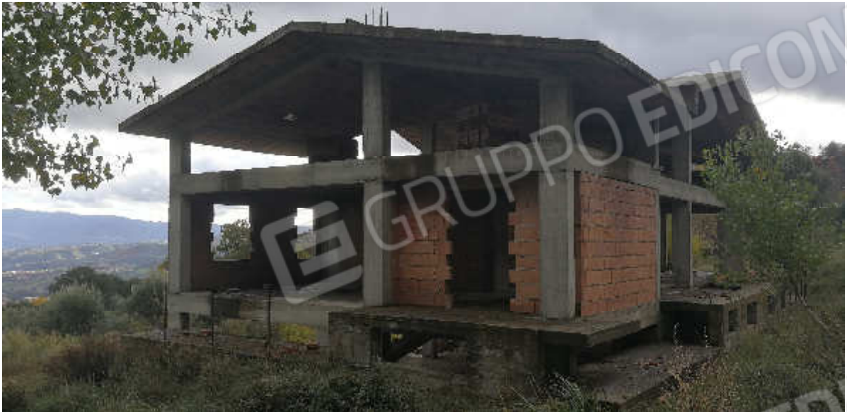
FOTO N. 02 – FABBRICATO IN CORSO DI COSTRUZIONE ENTROSTANTE IL LOTTO DI TERRENO OGGETTO DI PIGNORAMENTO
