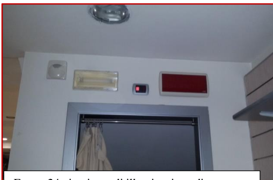
Foto n.24 – impianto di illuminazione di sicurezza
