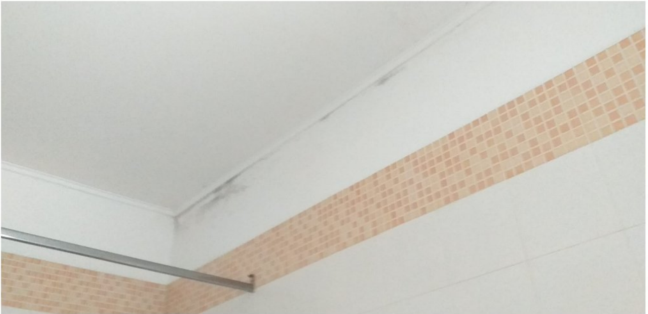
FOTO N° 15 – particolare delle infiltrazioni bagno
