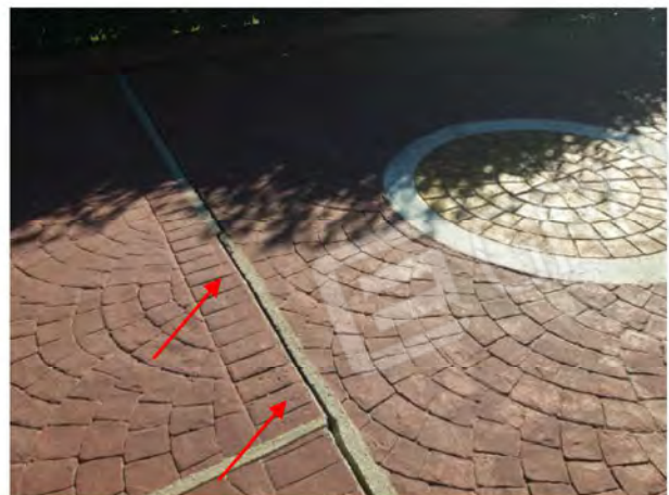
Foto 10: Corte privata zona centrale. Particolare lesioni pavimentazione
