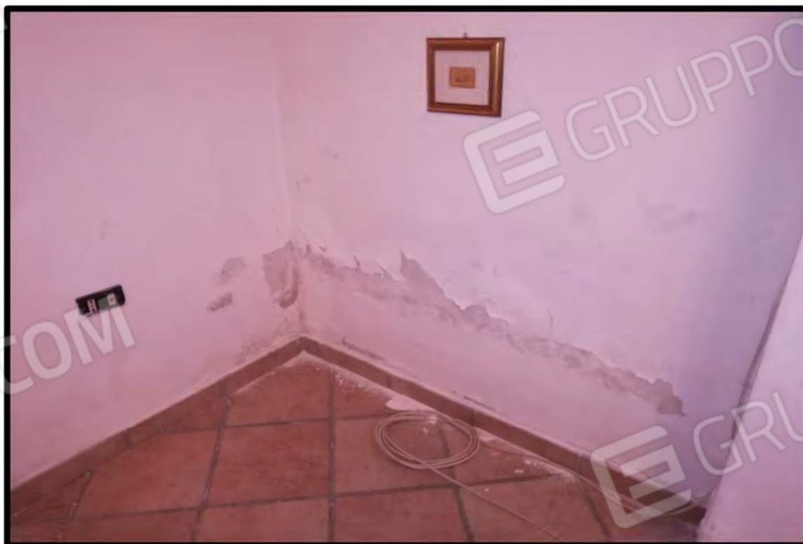
PARTICOLARE INTERNO UMIDITA PER RISALITA CAPILLARE SULLE MURATURE
