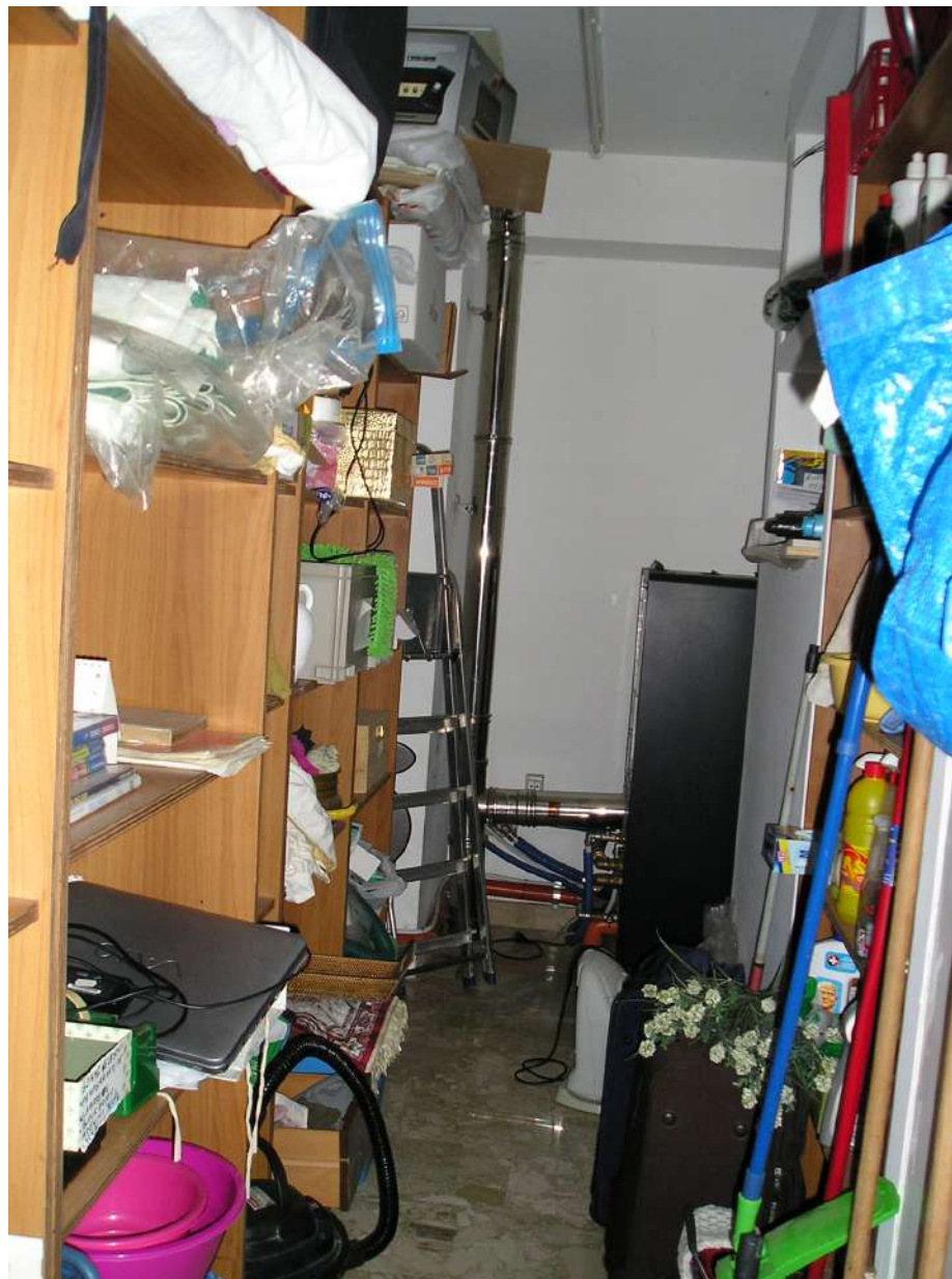
Foto n. 22: Ripostiglio in cui è installata la stufa a pellet – Lotto 3
