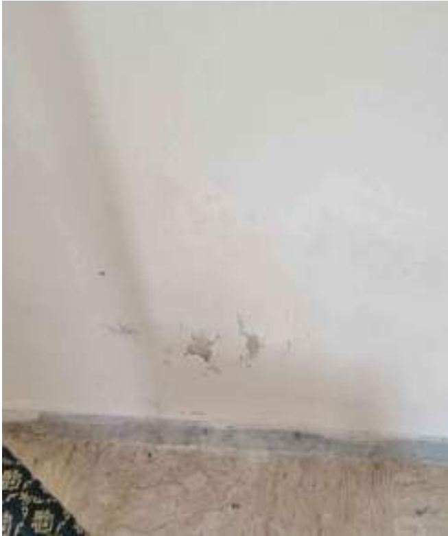
Fig.38 -39) particolare delle pareti con evidenti tracce di umidità e muffa
