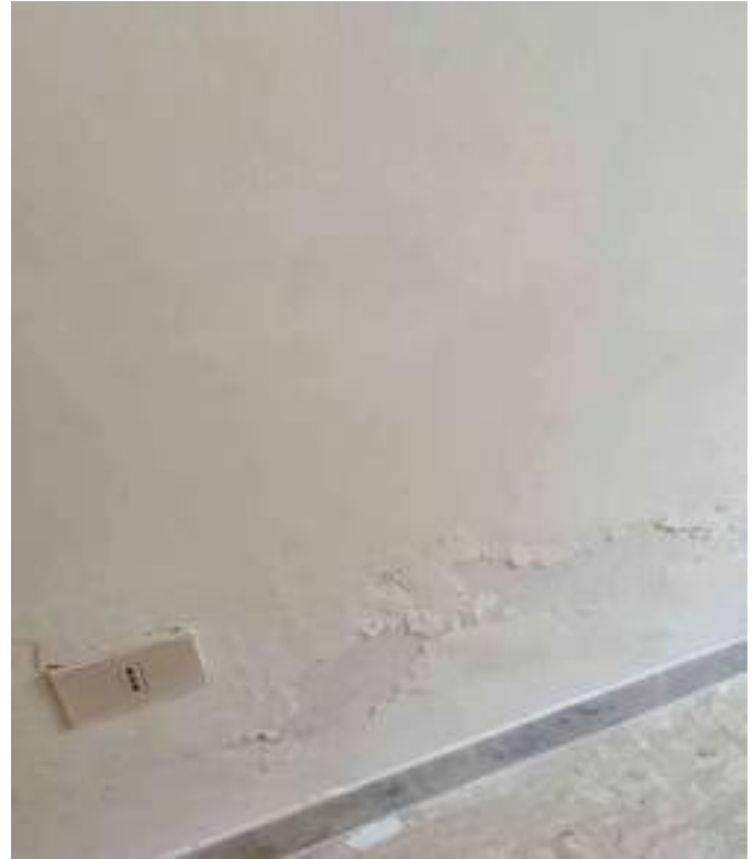
Fig.36 - 37) particolari delle tracce di umidità, infiltrazioni d'acqua
