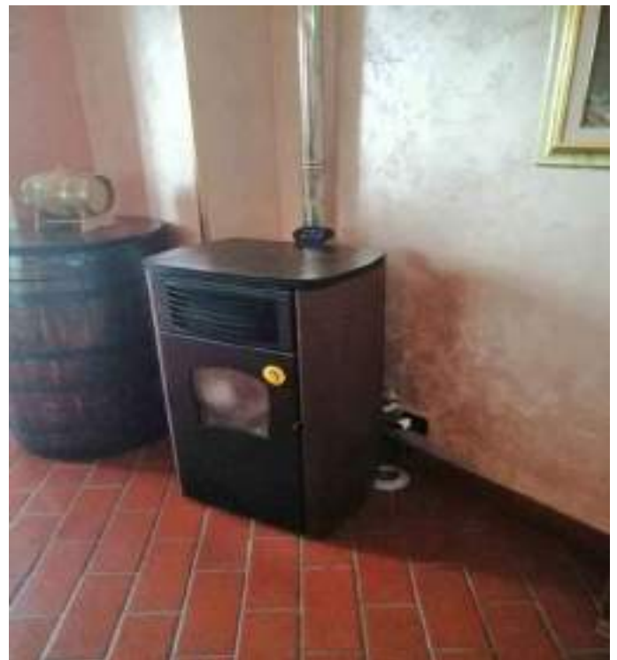
Fig.52) Particolare della stufa a pellet
