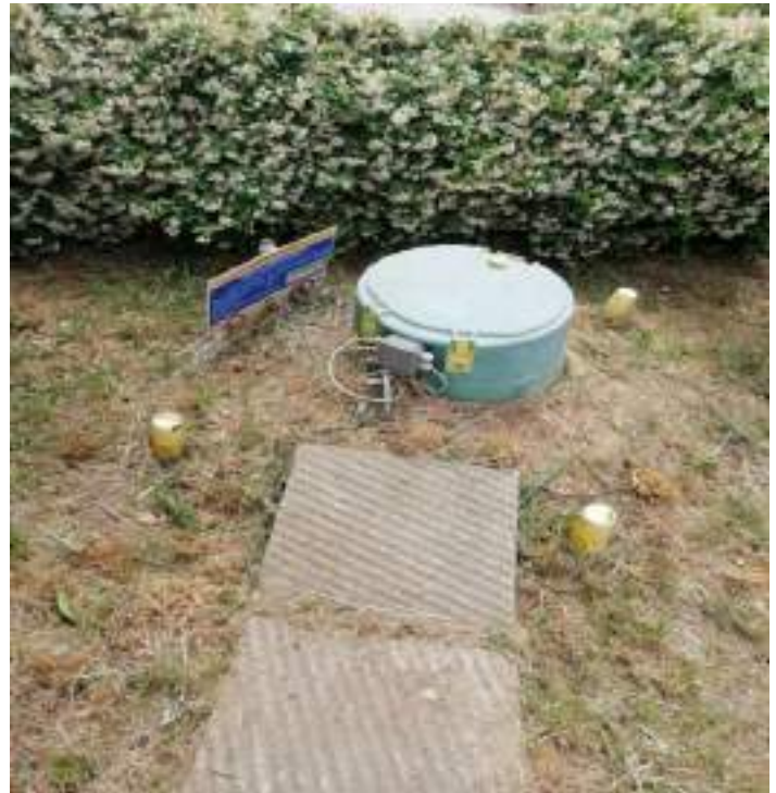
Fig.69) Particolare del bombolone esterno
