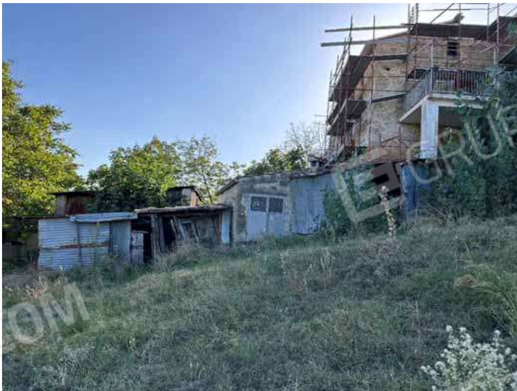
Foto 2: Baracche costruite sulla corte della unità immobiliare Fg. 4 P.IIa 433 sub 1 e terreno limitrofo.
