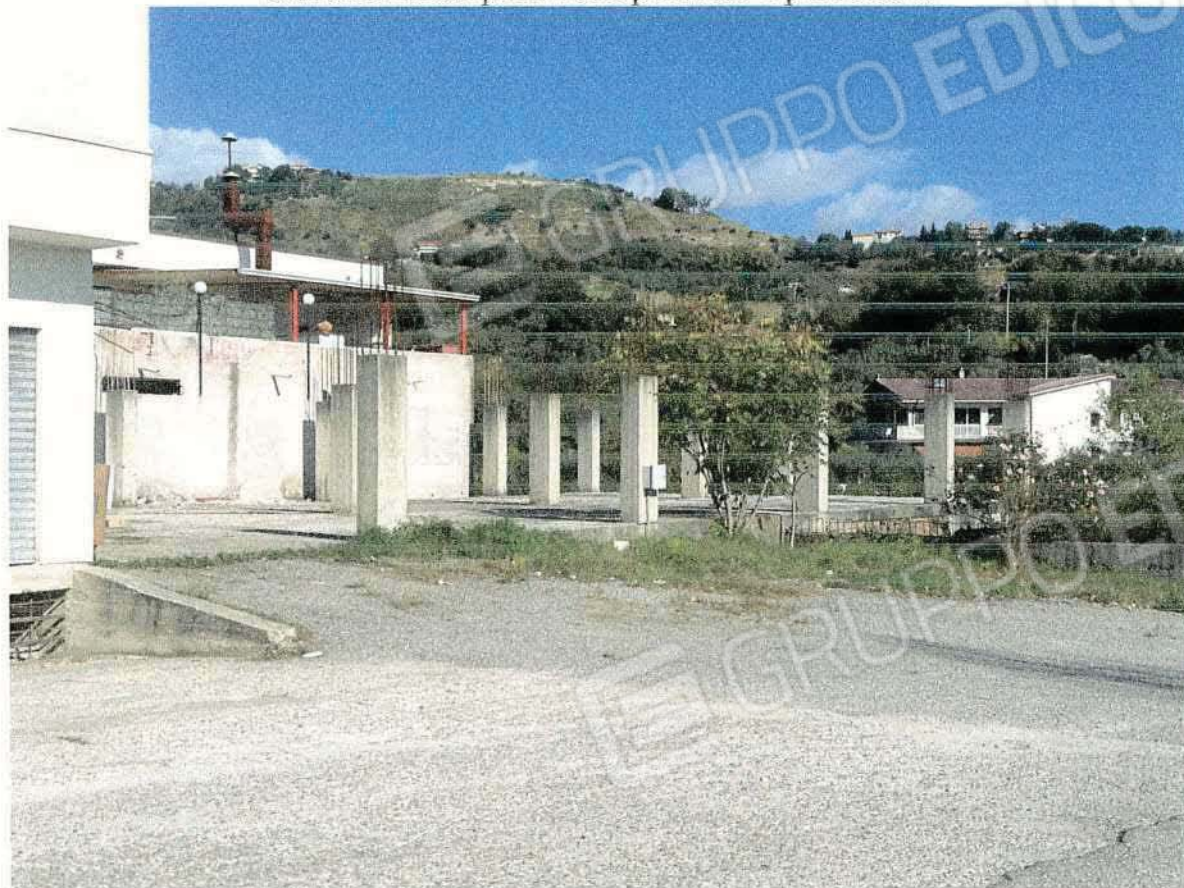
Struttura incompleta sulla p.lla 265 e p.lla 263\\
