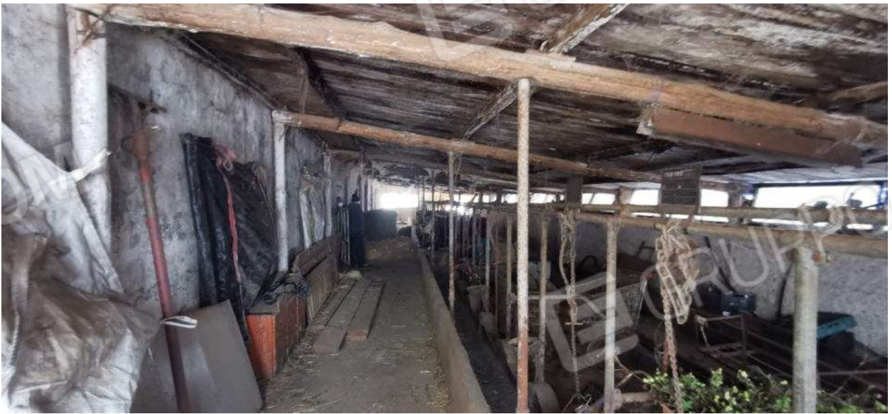
Foto 21: Stalla - corpo aggiunto
