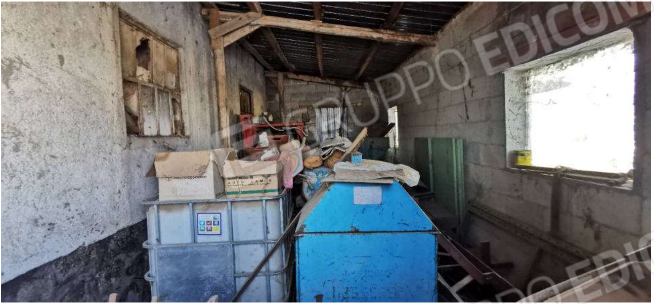
Foto 22: Stalla - corpo aggiunto.
