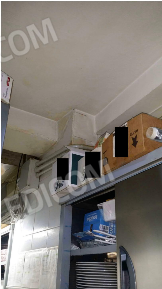
Foto n. 31 – macchie umidità cucina
