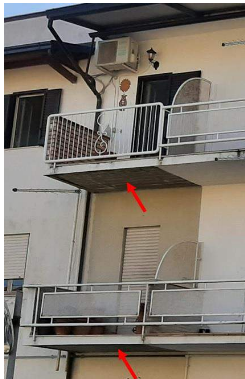
Foto 14. Intradosso balconi privo di intonaco.
