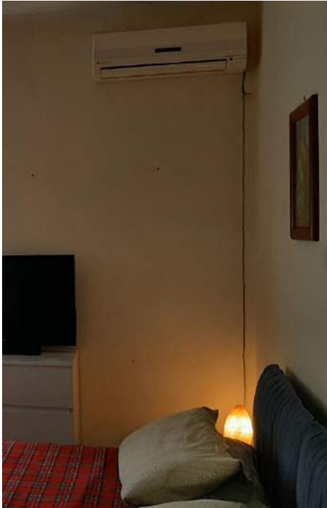
Foto 20. Condizionatore in camera matrimoniale.
