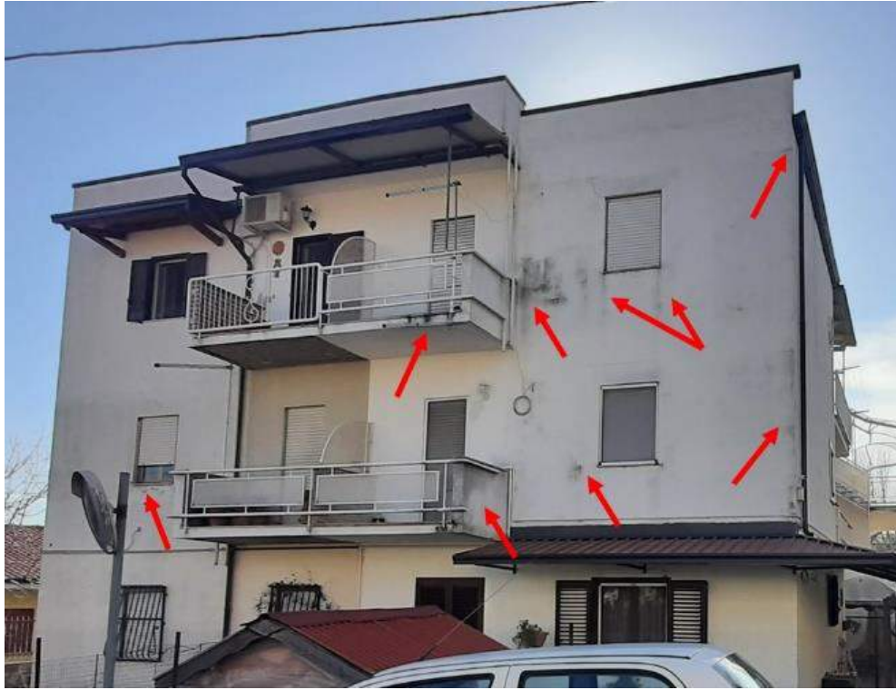
Foto 15. Zone ammalorate su uno dei prospetti.
