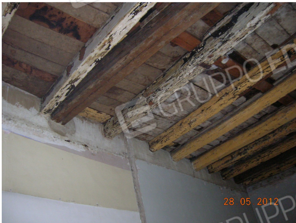
FOTO N. 09 STATO DI CONSERVAZIONE DEL SOLAIO DEL PIANO SUPERIORE
