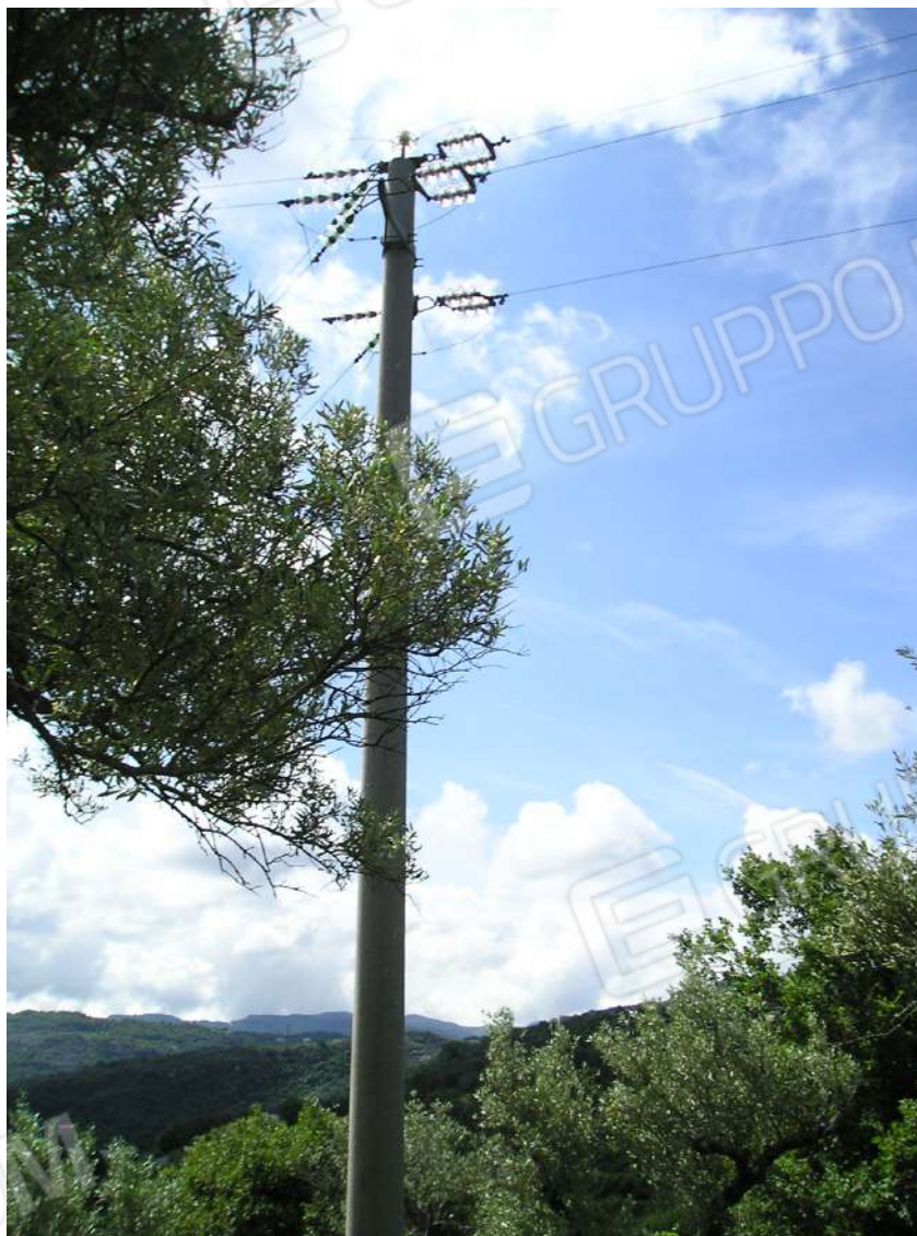
Foto n. 41: Immobile 3 – particolare elettrodotto
