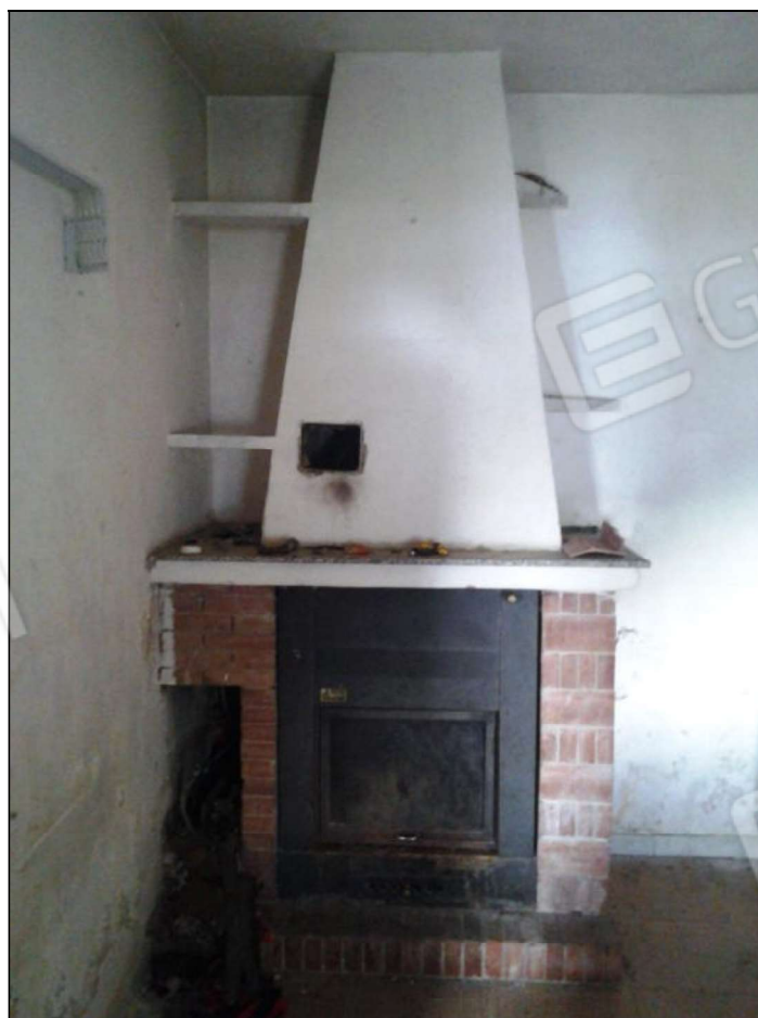
Fotografia 16: termo camino all'interno della cucina del fabbricato rurale ispezionato.
