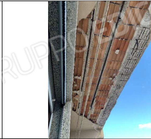
VISTA ESTERNA NEGOZIO (Cespite 3) PENSILINA ESTERNA CON CADUTA INTONACI
