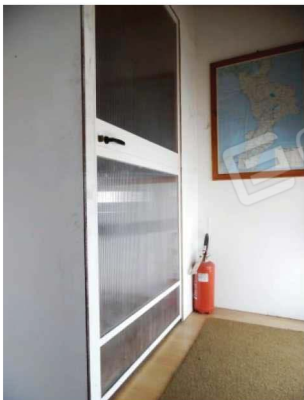
Foto 23-Porta d'ingresso locali abusivi posti al livello superiore -
