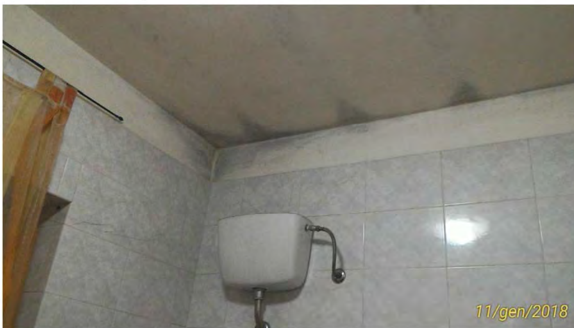
Fig. 26 – Visione particolareggiata umidità nei solai
