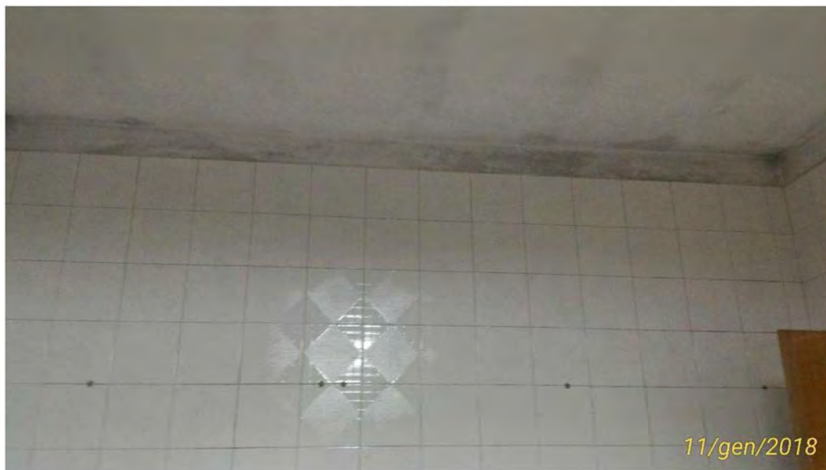
Fig. 27 – Visione particolareggiata umidità nei solai
