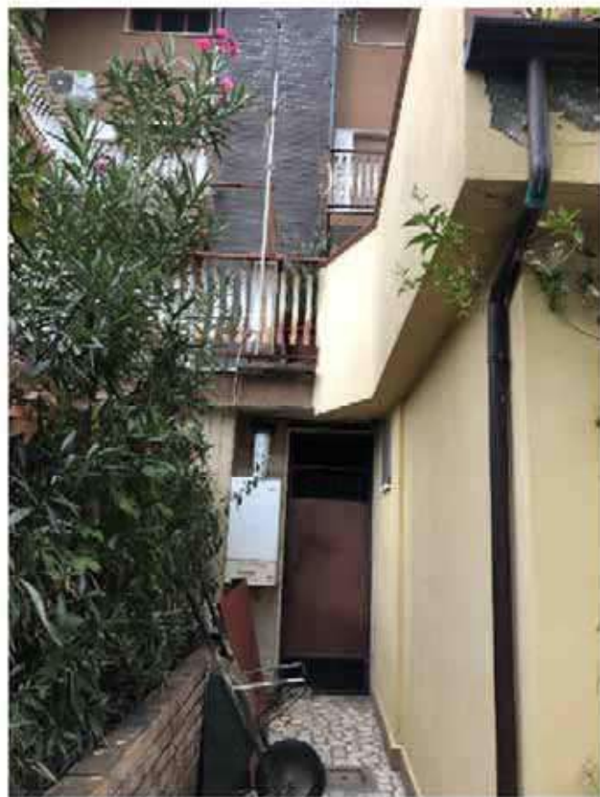
Foto 8 – Ingresso locale caldaia al piano seminterrato lato Ovest.
