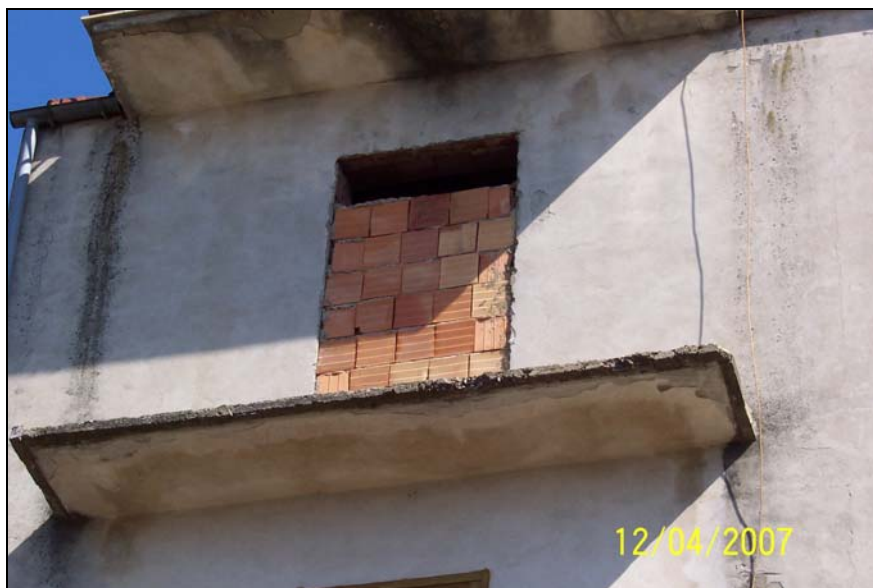
Fotografia n° 2: balcone murato e senza ringhiera
