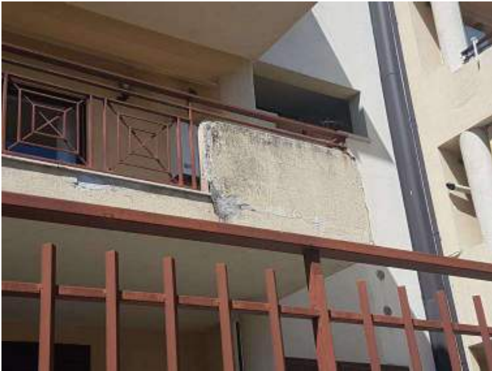
Foto 52: parete ammalorata - palazzina
