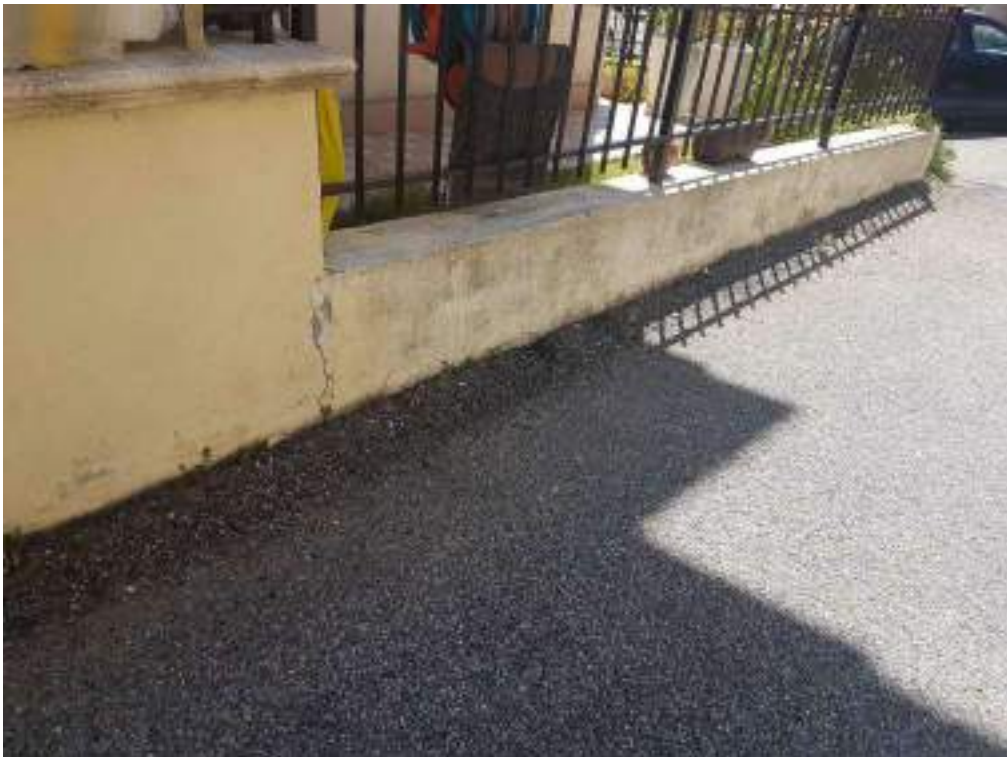
Foto 50: distacco intonaco - palazzina
