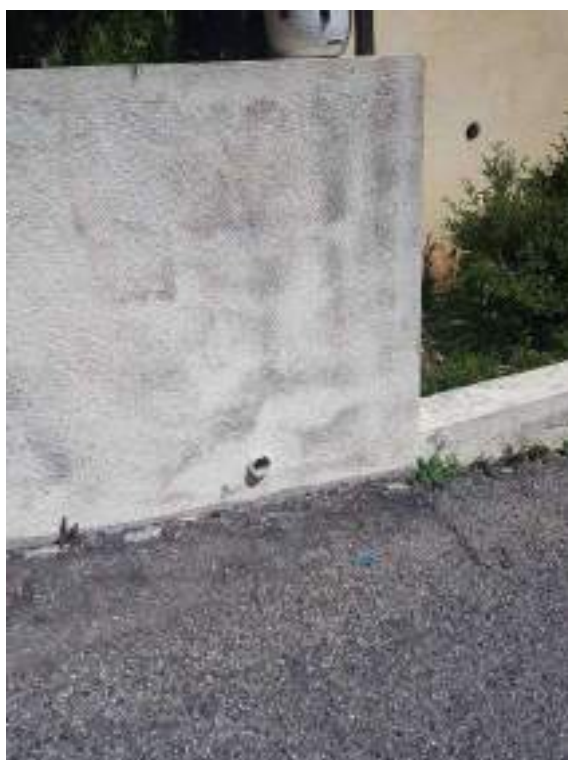
Foto 44: parete esterna palazzina, insalubre, soggetta alle intemperie
