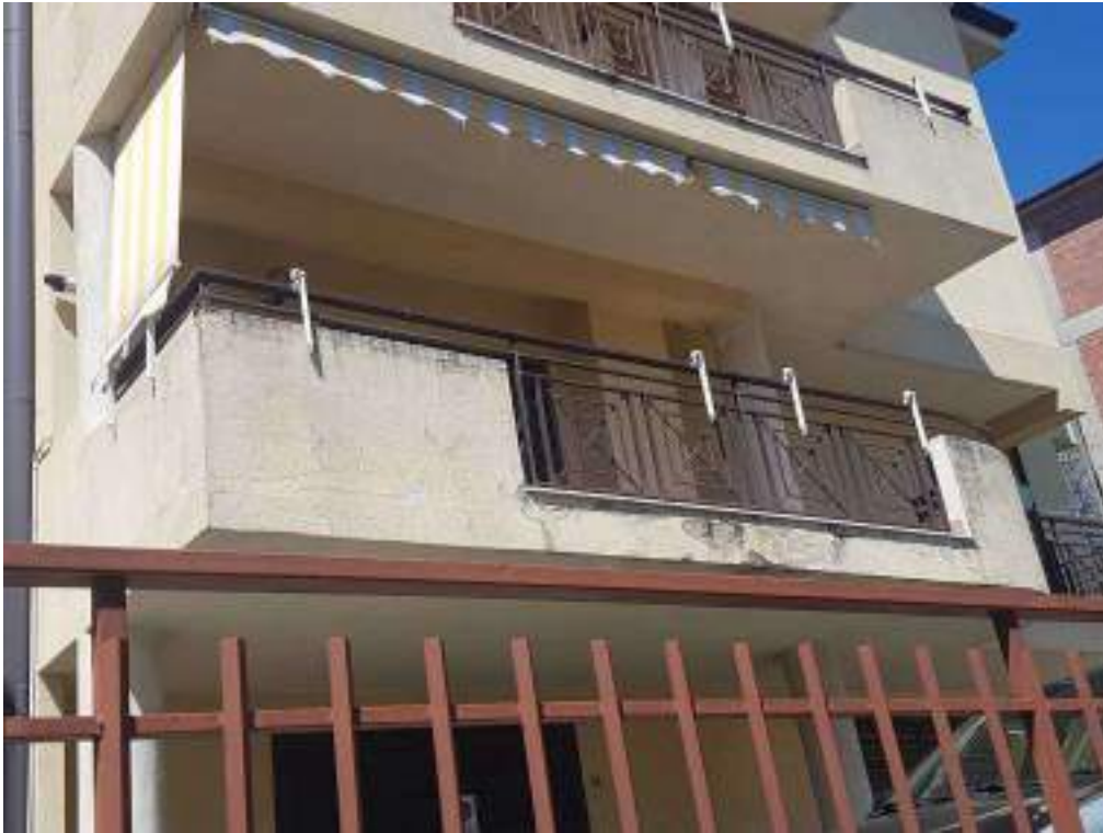
Foto 53: parete ammalorata - palazzina
