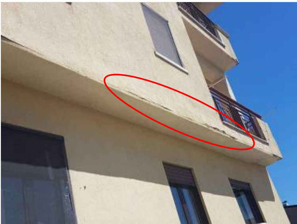
Foto 46: intonaco mancante - palazzina
