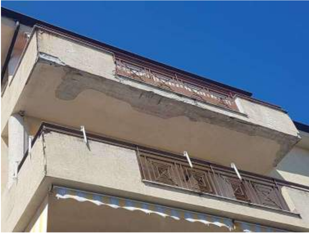
Foto 51: distacco intonaco - palazzina
