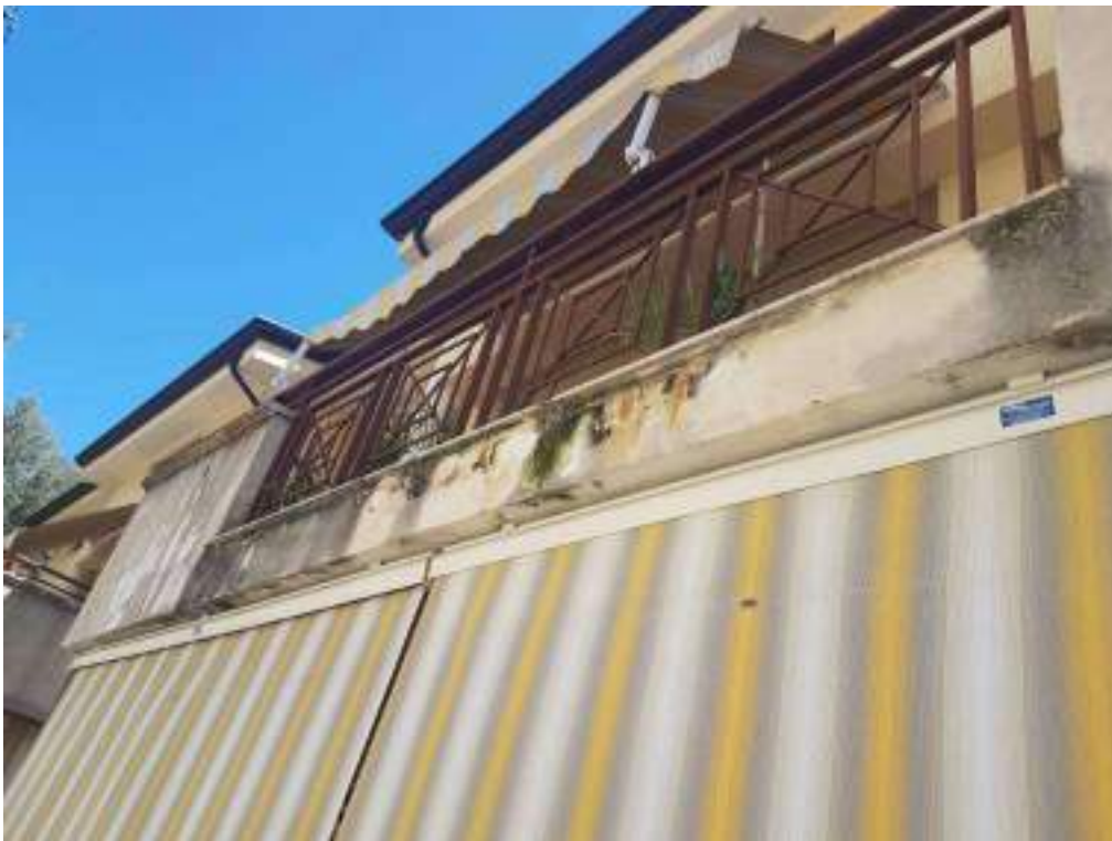
Foto 48: parete ammalorata e insalubre - palazzina
