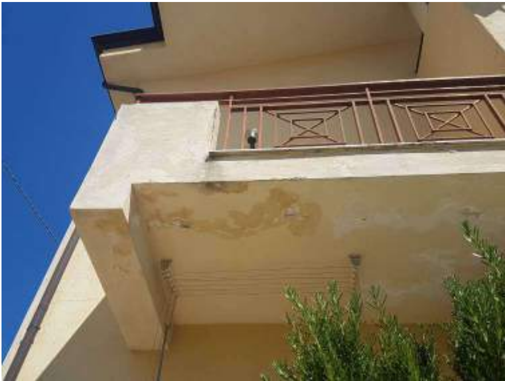
Foto 45: intonaco ammalorato e mancante - palazzina
