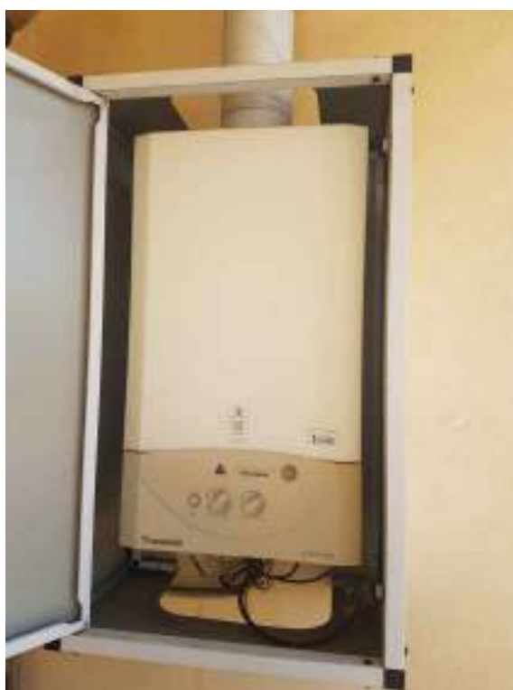
Foto 40: caldaia posizionata sul balcone
