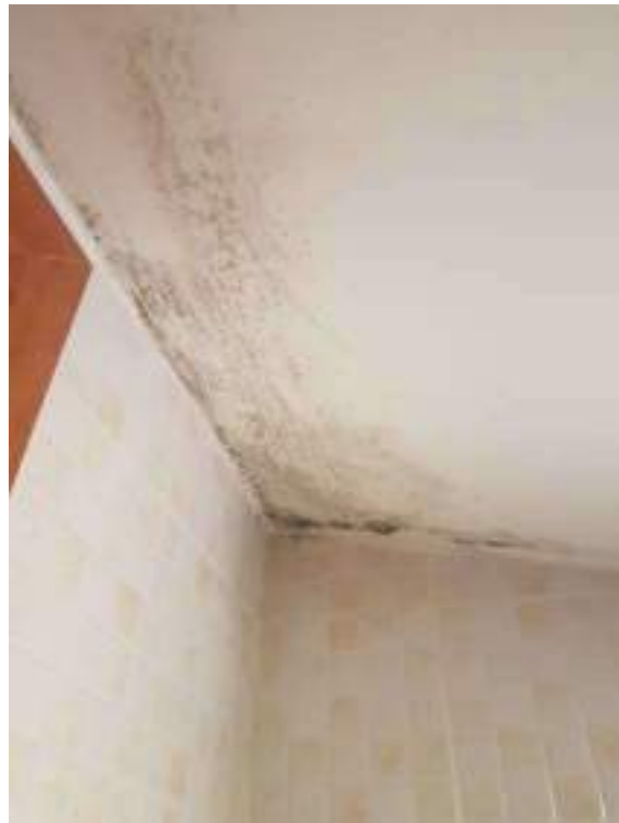
Foto 42: presenza di muffa
