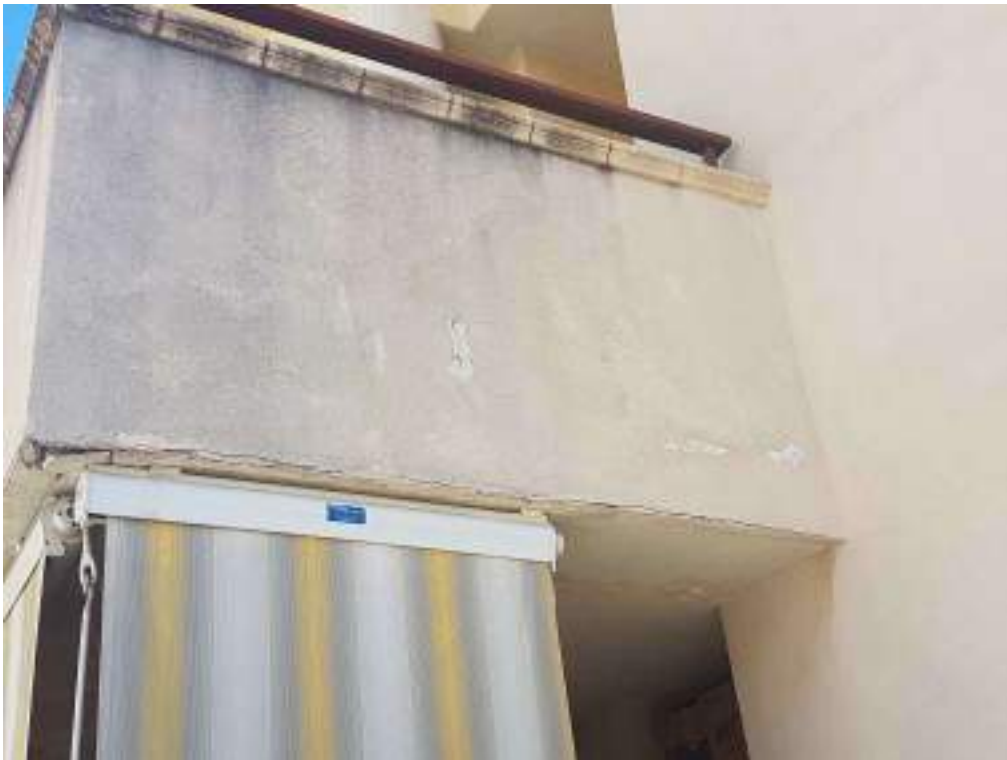
Foto 47: parete ammalorata e insalubre - palazzina
