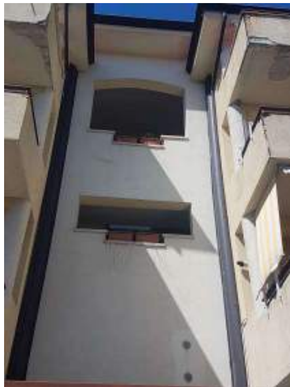
Foto 54: pareti ammalorate e esterno vano scala - palazzina
