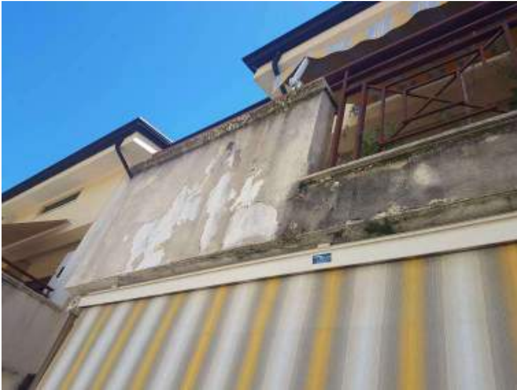
Foto 49: parete ammalorata e insalubre - palazzina
