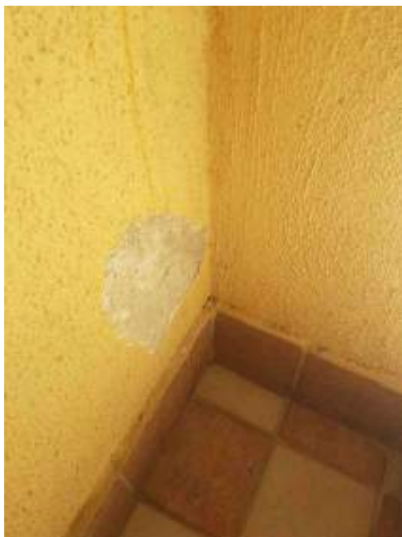
Foto 43: intonaco deteriorato e mancante
