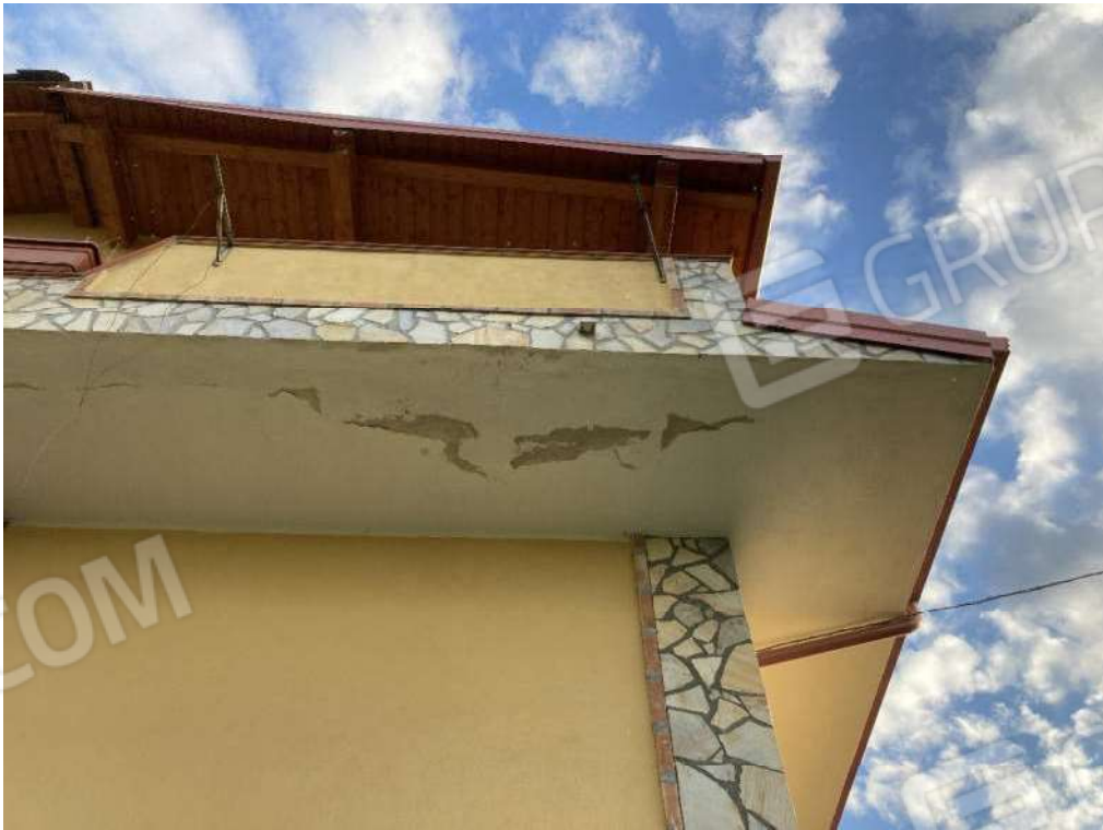
Foto 7 – Particolare degrado terrazzo primo piano
