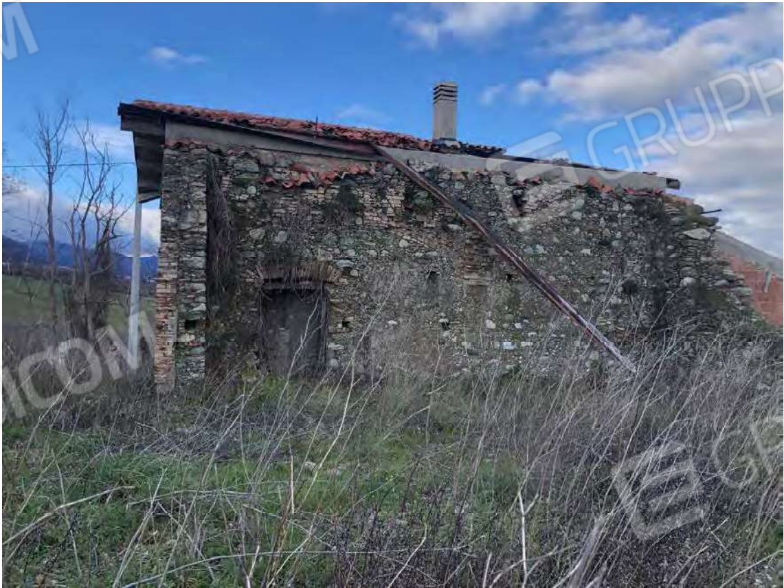
Foto 136 - San Benedetto Ullano (CS). Fabbricato diruto fg.7, p.la 35-36
