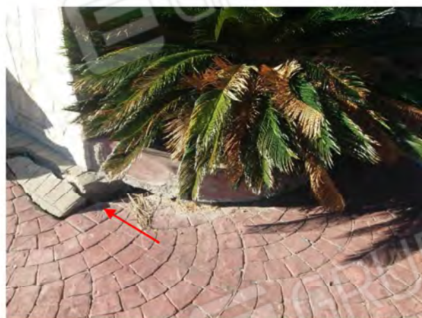
Foto 16: Spigolo Nord-Est fabbricato. Lesioni pavimentazione
