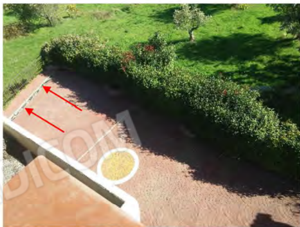
Foto 15: Vista dall'alto della corte zona Nord. Lesioni evidenti e distacco nei pressi della griglia di raccolta acque meteoriche
