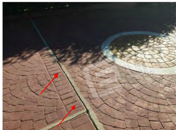
Foto 10: Corte privata zona centrale. Particolare lesioni pavimentazione
