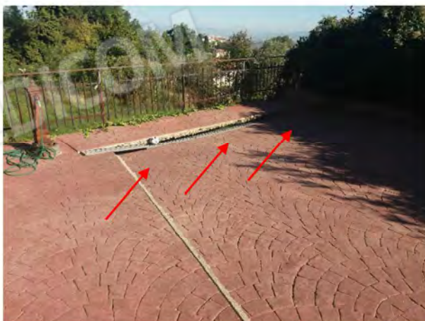
Foto 9: Corte privata lato Nord. Particolare lesioni pavimentazione
