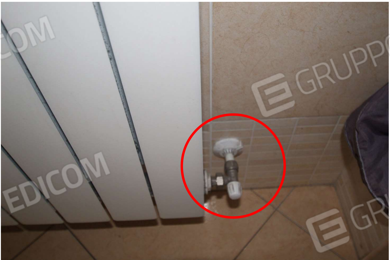
Particolare impianto idrico: tubo in multistrato
