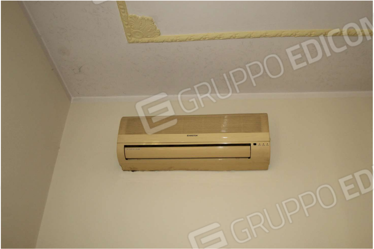
Climatizzatore: unità interna
