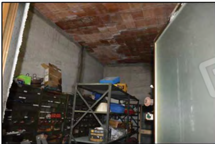
Foto 38: Magazzino Fgl 1 part. 101 sub 9- Vista interna, comunicazione abusiva con locale intercapedine.
