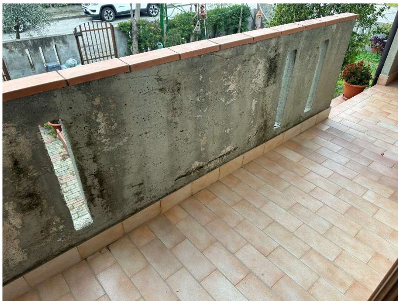
Foto 3: Interno parapetto terrazza ingresso.
