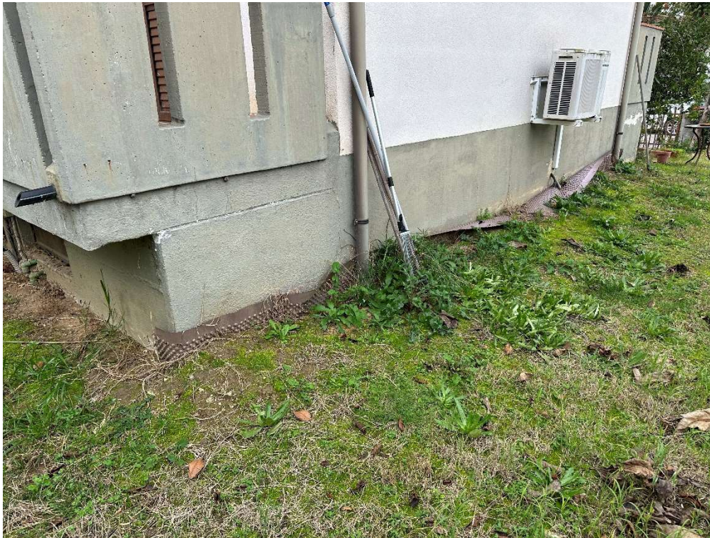
Foto 6: Guaina pareti interrato.
