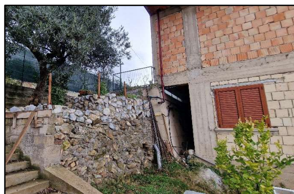
Fig. n.21 – Stato attuale muro
